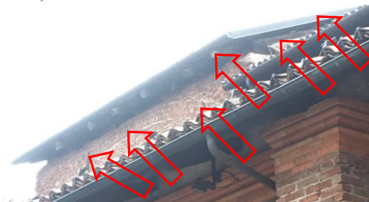
FOTOGRAFIA 44S – LA PARETE ESTERNA DELLA CAMPATA C 4 CON LA COPERTURA RIALZATA, I FIANCHI CON ARCHI RIBASSATI LE STAFFE PER LE CHIAVI A BRAGA E LE PARTI SOTTOGRONDA
