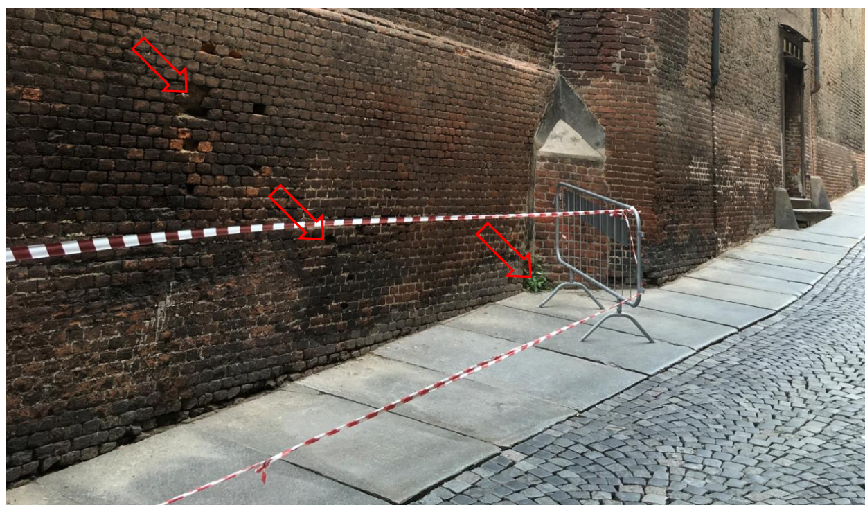
FOTOGRAFIA 139 – LA BASE DELLA MURATURA LATERALE CON LA MANCANZA DI PARTI DI LATERIZIO, IL RINFORZO ANGOLARE E LA FORMAZIONE DI INFLORESCENZE
