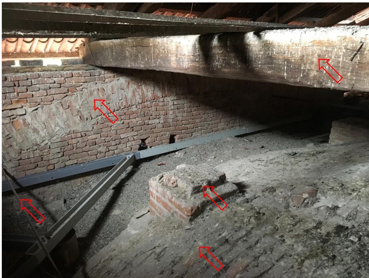
FOTOGRAFIA 46S – IL LATO INTERNO VERSO IL CORTILE DELLA CAMPATA C 4 CON L'ARCO RIBASSATO, LA VOLTA, GLI APPOGGI, LA CATENA DI UNA CAPRIATA E LA CHIAVE A BRAGA
