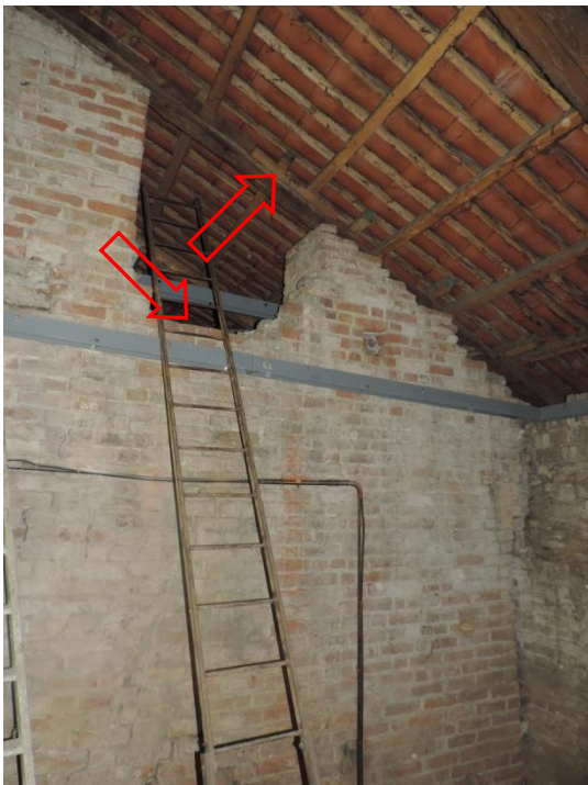
FOTOGRAFIA 10S – L'ACCESSO DA N 2 AD N 3 E ALLE RESTANTI PARTI DEL SOTTOTETTO DELLA NAVATA DESTRA
