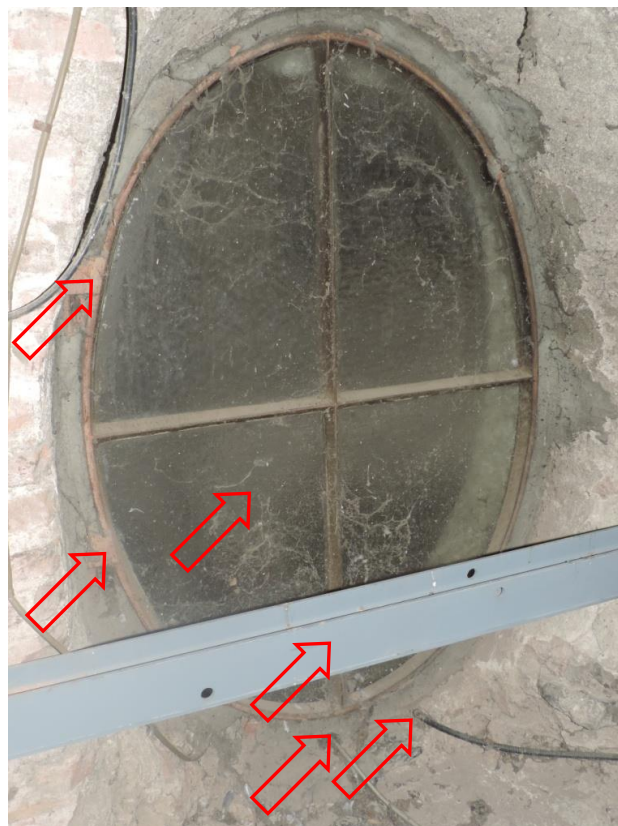
FOTOGRAFIA 24S – LA FINESTRA ELLITTICA BLOCCATA DAL CORDOLO
