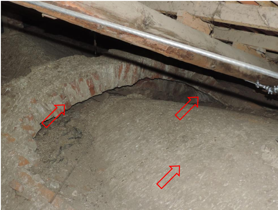
FOTOGRAFIA 20S – ARCATA O VECCHIA VOLTA INTONACATA
