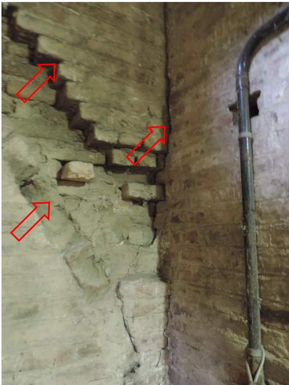
FOTOGRAFIA 3S – COLLEGAMENTO IN N 1 TRA IL MURO DI FACCIATA E QUELLO DI SEPARAZIONE TRA LE NAVATE LATERALE E CENTRALE
