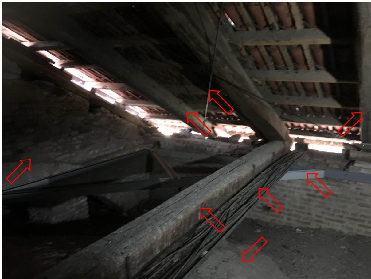
FOTOGRAFIA 51S – LA CAPRIATA, IL FASCIO DI CAVI, I FALSI PUNTONI CON CONTROVENTATURA, IL CORDOLO, LA SOTTOSTANTE VOLTA E IL TIMPANO SU ARCO DI SCARICO
