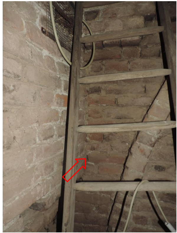
FOTOGRAFIA 2S – COLLEGAMENTO IN N 1 TRA IL MURO LUNGO VIA PRINCIPESSA MARIA CLOTILDE DI SAVOIA E QUELLO DI FACCIATA
