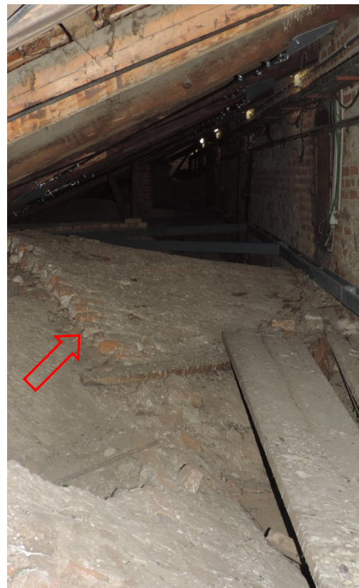
FOTOGRAFIA 19S – LA VOLTA IN PARTE RICOSTRUITA
