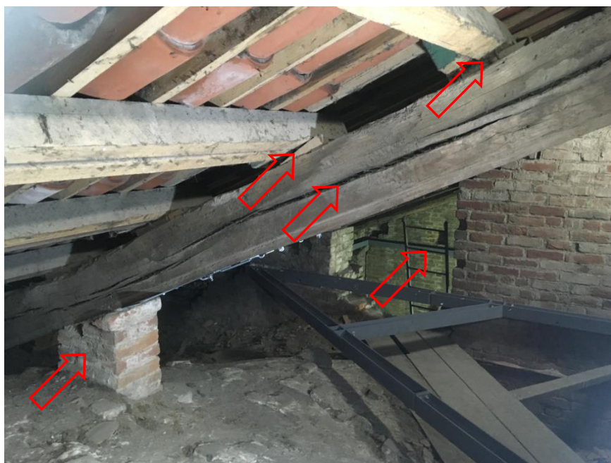
FOTOGRAFIA 13S – IL FALSO PUNTO FESSURATO APPOGGIATO SULLA VOLTA IN N 3
