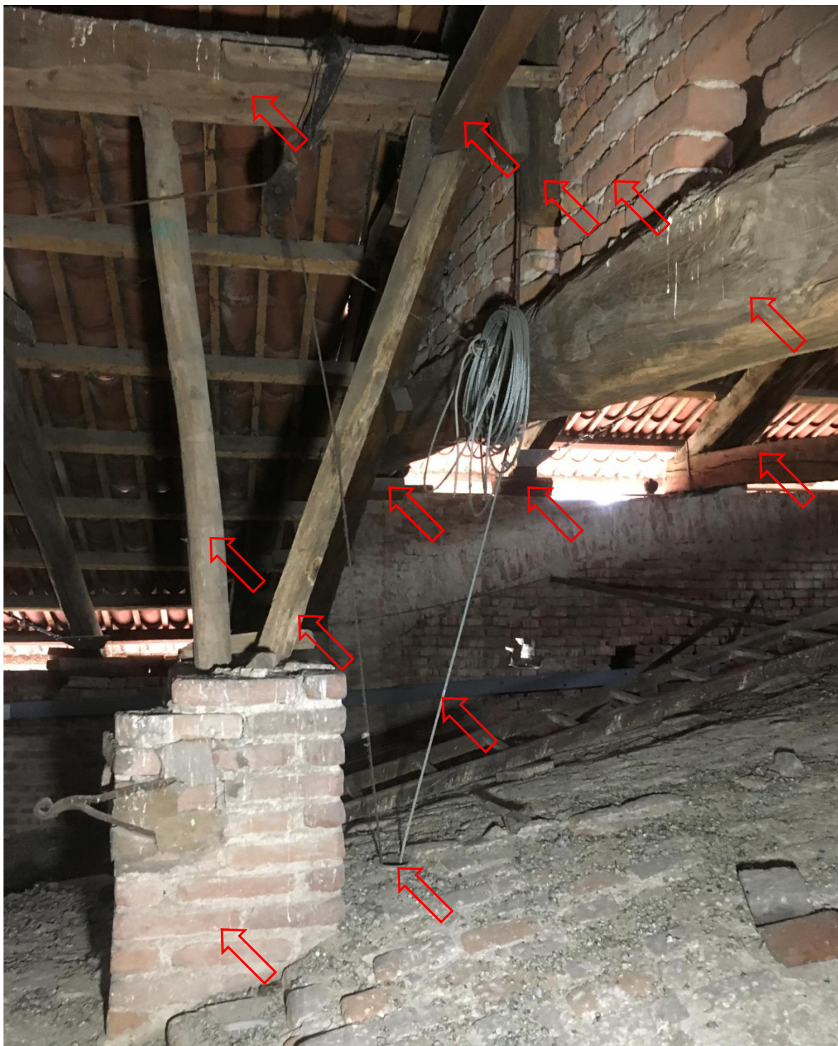
FOTOGRAFIA 49S – LA PARTE CONCLUSIVA DELLA CAMPATA C 4 CON IL TIMPANO SU CATENA, IL FORO NELLA VOLTA PER IL PASSAGGIO DELLE FUNI METALLICHE DI SOSTEGNO AL CROCEFISSO E IL PILASTRINO CON L’APPOGGIO DEL COLMO E DELLA CONTROCATENA IN P 1
