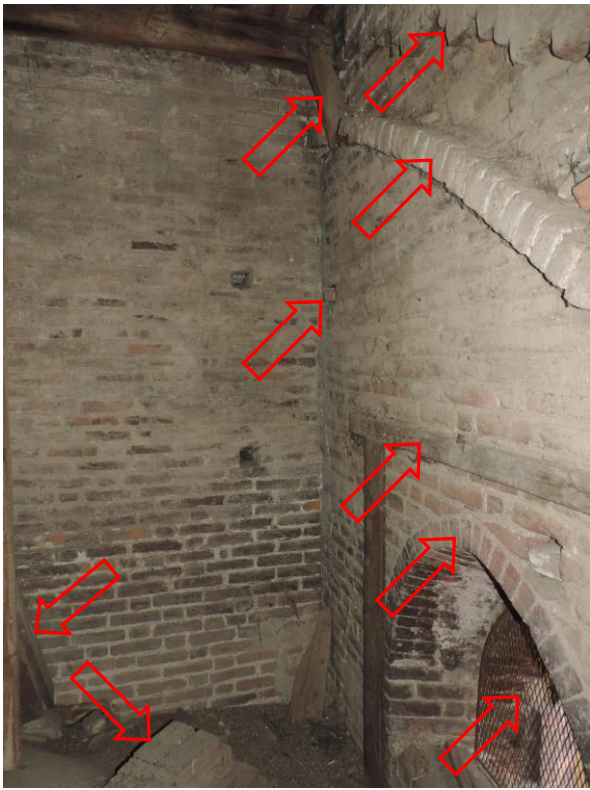
FOTOGRAFIA 1S – COLLEGAMENTO IN N 1 TRA IL MURO DI DIVISIONE E QUELLO LUNGO VIA PRINCIPESSA MARIA CLOTILDE DI SAVOIA
