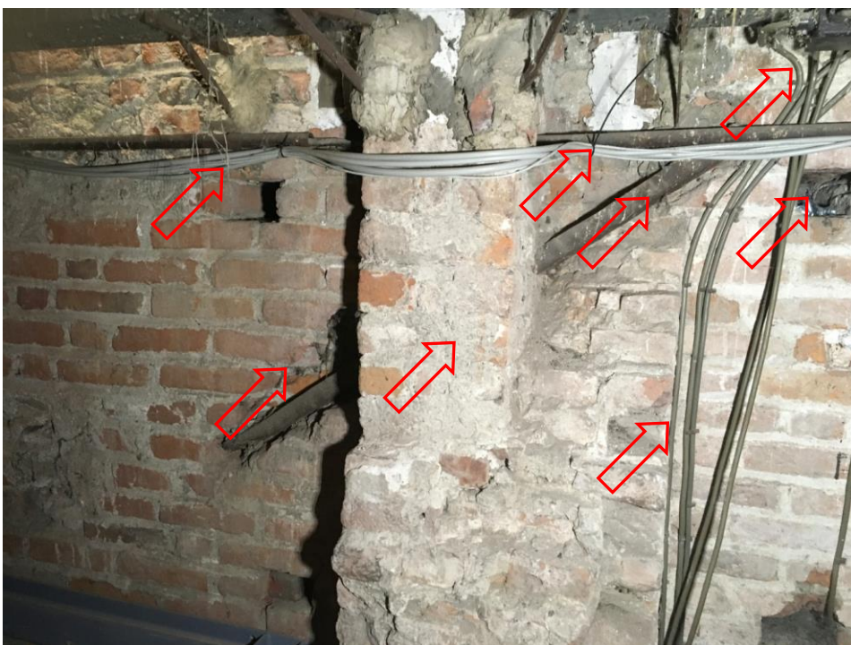
FOTOGRAFIA 21S – STAFFA PER TIRANTE PRESENTE NELLA PARTE INTERNA DELLA CHIESA
