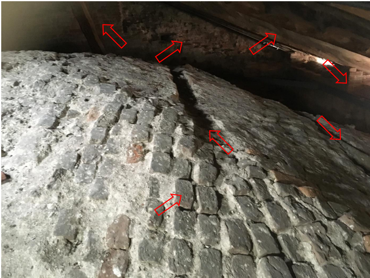
FOTOGRAFIA 38S – LE IMPRONTE DI PRECEDENTI APPOGGI DIRETTI, LA COLLOCAZIONE DEI MATTONI LUNGO IL LATO DI PUNTA, LA SISTEMAZIONE DEI FALSI PUNTONI, LA PARTE DETERIORATA DELLA MURATURA INTERNA DEL TIMPANO E LA SUA SAETTA
