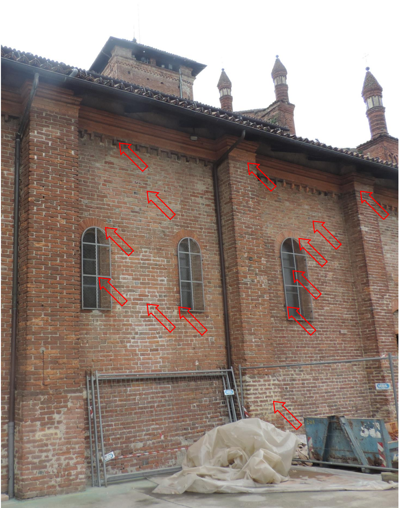
FOTOGRAFIA 181 – I SETTORI ESTERNI DI MURATURA CORRISPONDENTI ALLA SECONDA CAMPATA DELLA QUARTA NAVATA
