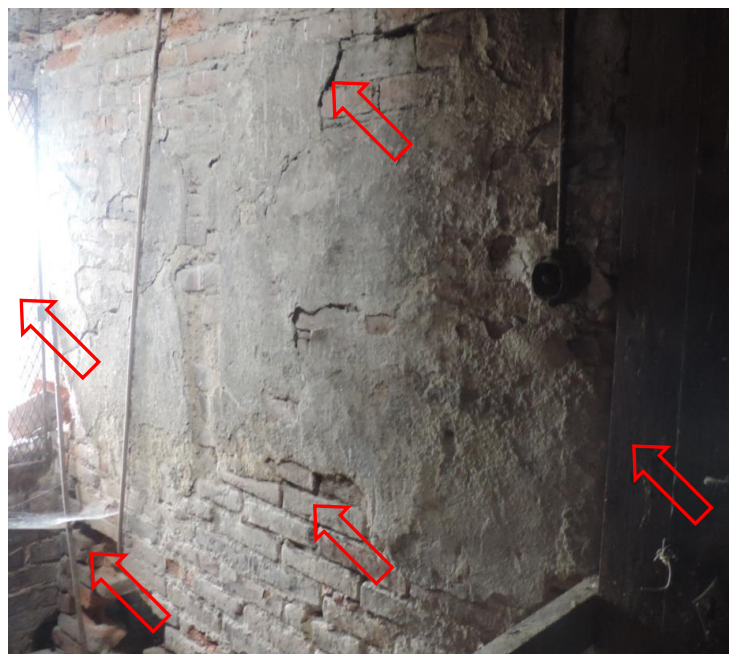
FOTOGRAFIA 33S – IL MURO DETERIORATO DELLA CELLA PER IL MECCANISMO DELL'OROLOGIO
