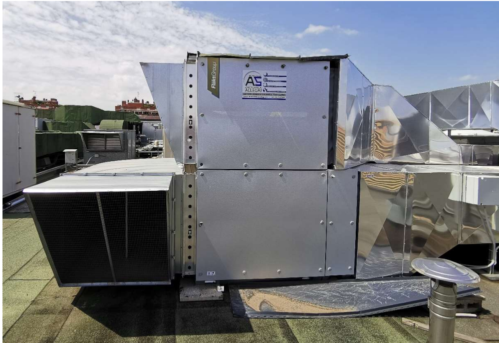
Figura 26 – Unità di Trattamento Aria installata nel centro fitness Gold's Gym di Milano
