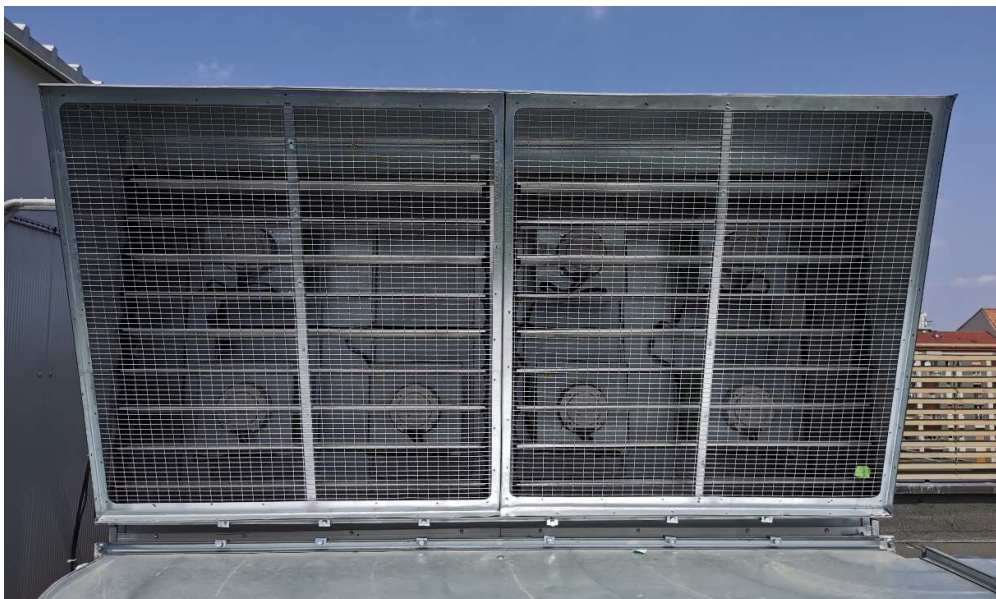
Figura 27 – Ventilatori dell'UTA installata nella palestra di Gold's Gym di Milano
