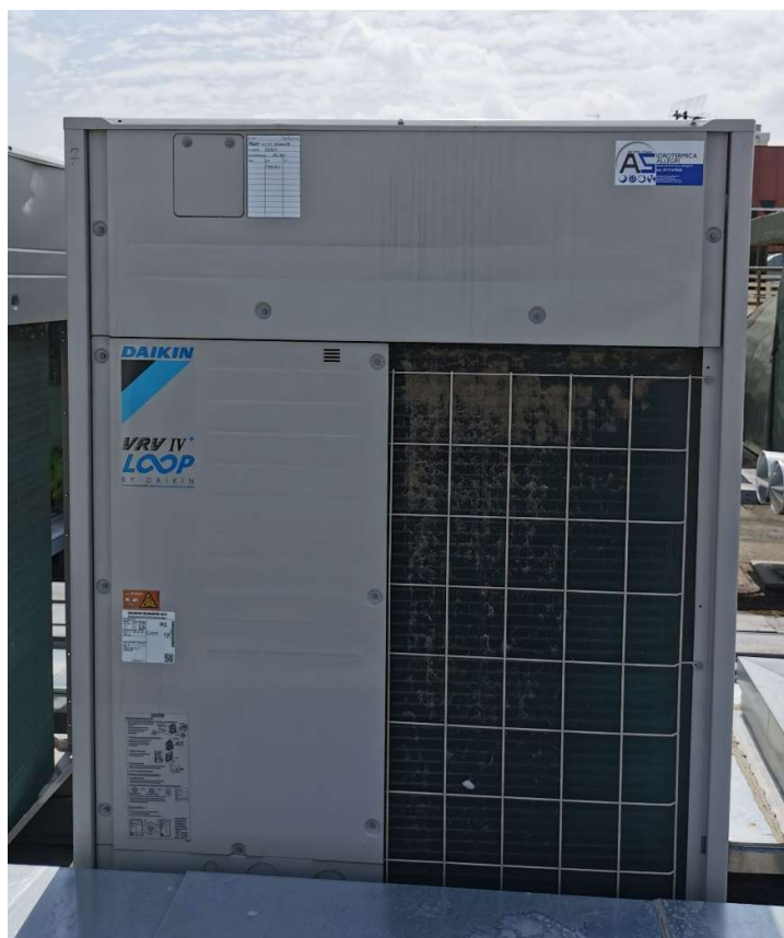
Figura 17 - Unità esterna del VRF installato nella palestra di Milano Gold's Gym
