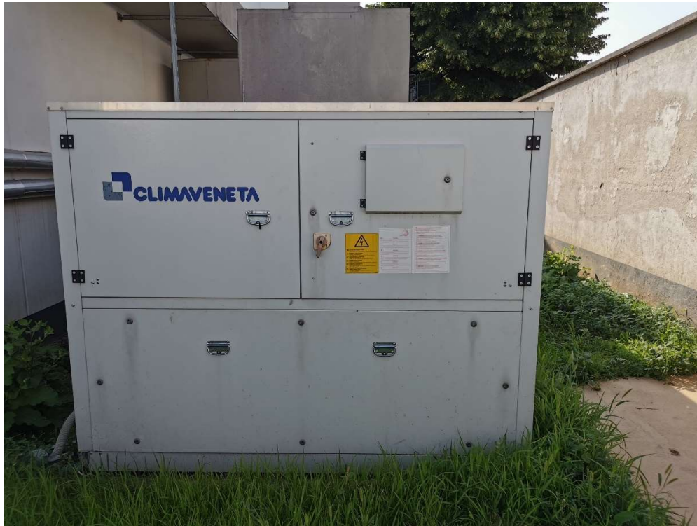
Figura 40 - Roof Top a servizio del centro fitness di Torino Mirafiori Nord
