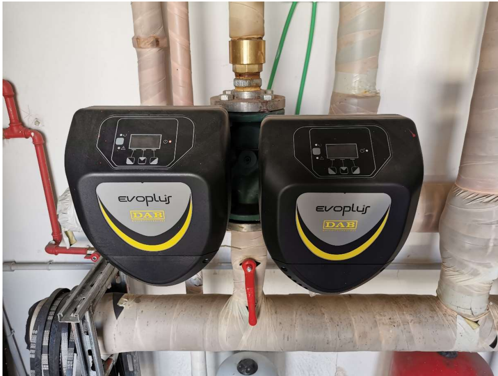
Figura 43 - Pompe gemellari installate nella centrale termica della struttura di Torino Mirafiori Nord
