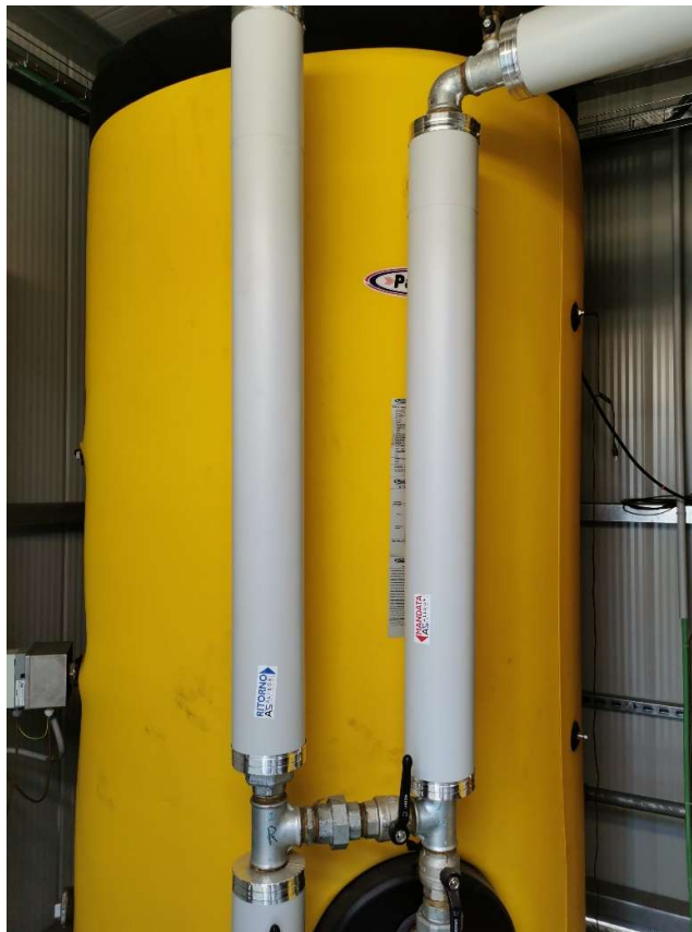
Figura 37 - Bollitore per la produzione di acqua calda sanitaria
