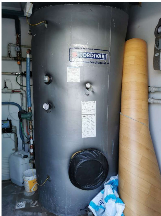
Figura 42 - Bollitore solare installato nel centro fitness di Torino Mirafiori Nord
