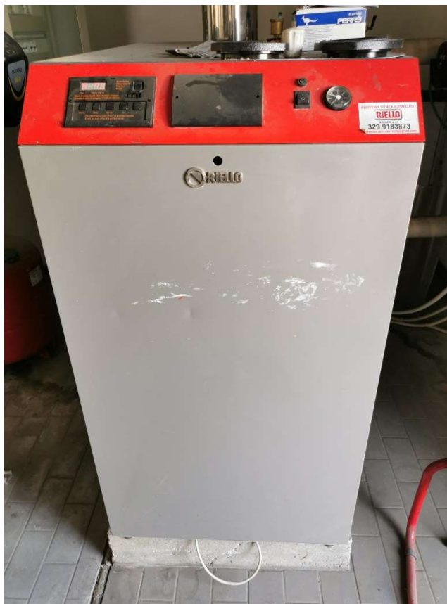
Figura 41 - Generatore di calore a gas naturale installato nella palestra di Torino Mirafiori Nord
