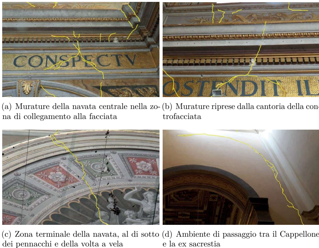
Figura 6.23: Lesioni diffuse nelle strutture del complesso ([34])
