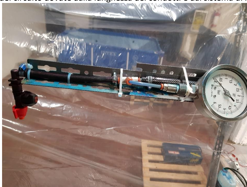
Figura 2.5-Manometro collegato in prossimità dell'ugello.
