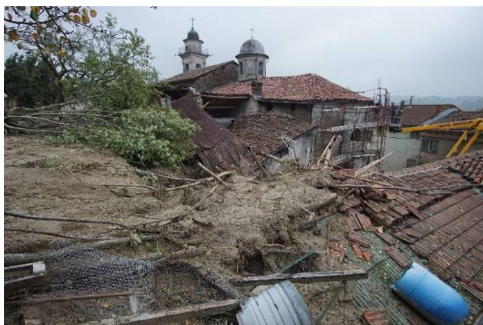
Figura 16 Danni al tetto dell'Oratorio dei Turchini causati da frane superficiali del versante (Fonte: Arpa Piemonte)
