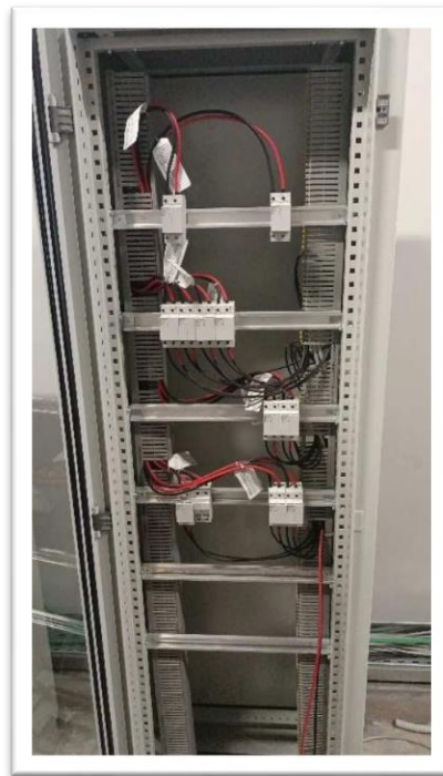
Figura 2.13: Quadro DC a vista interna.
