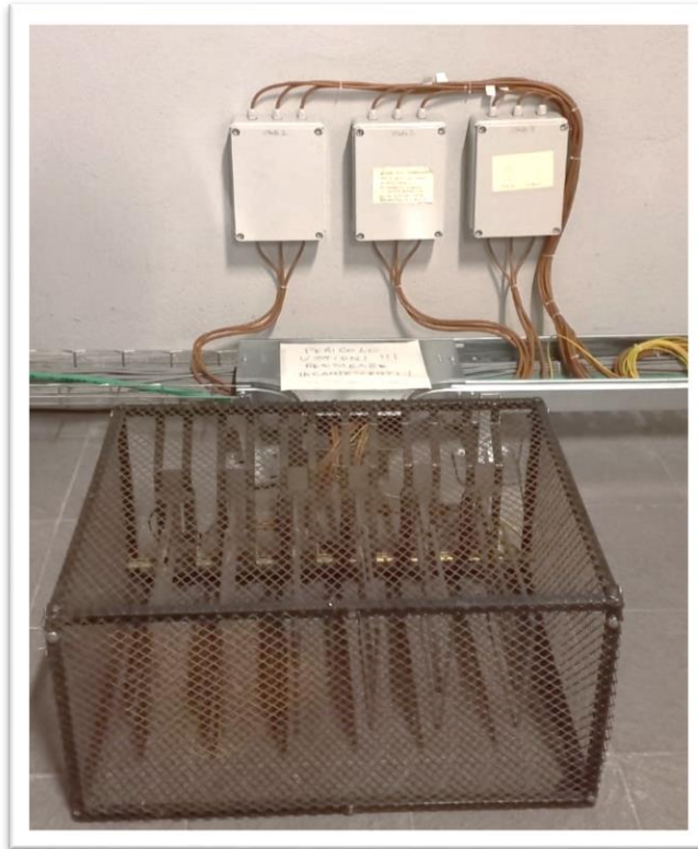
Figura 4.18: Sistema BACS sperimentale realizzato.
