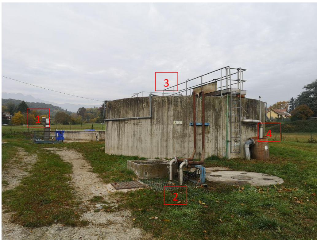
Figura 26 - Impianto di Depurazione Trana
