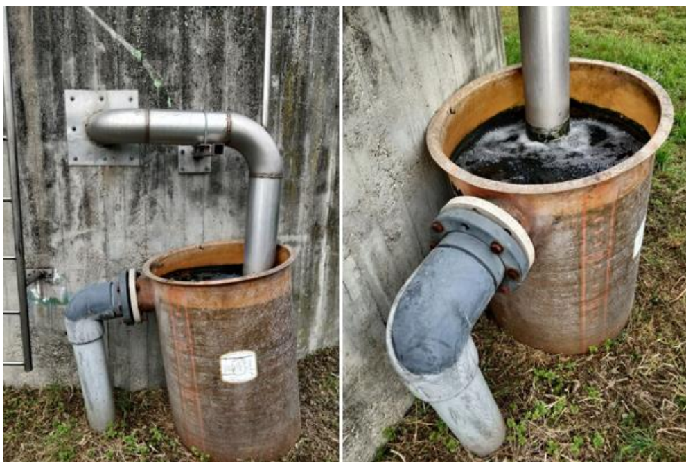
Figura 31 - Dettaglio serbatoio di raccolta
