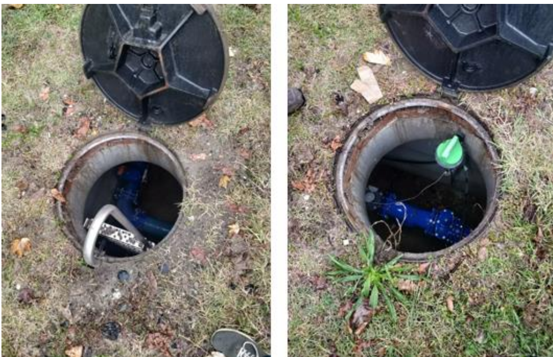
Figura 59 - Camera di manutenzione
