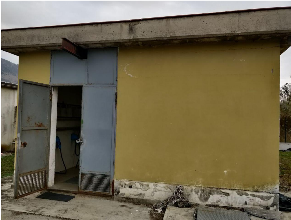
Figura 32 Camera pompe di sollevamento
