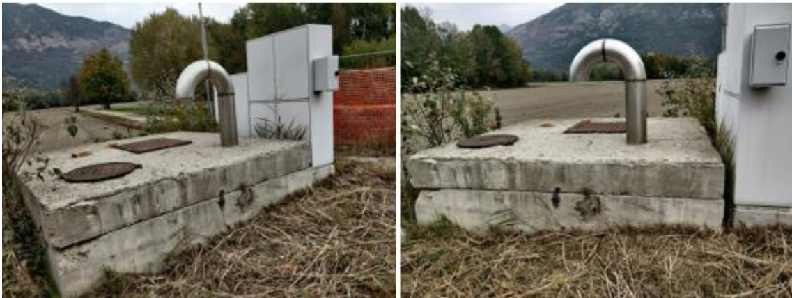
Figura 35 - Terminale acquedotto di valle
