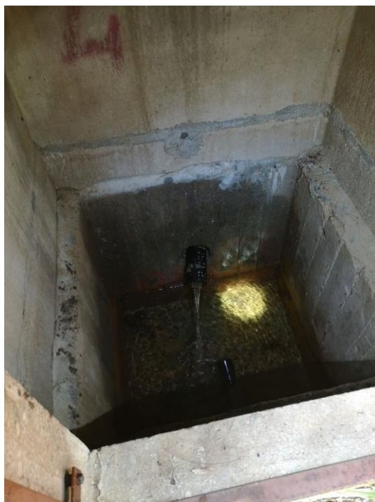
Figura 44 - Dettaglio interno sorgente
