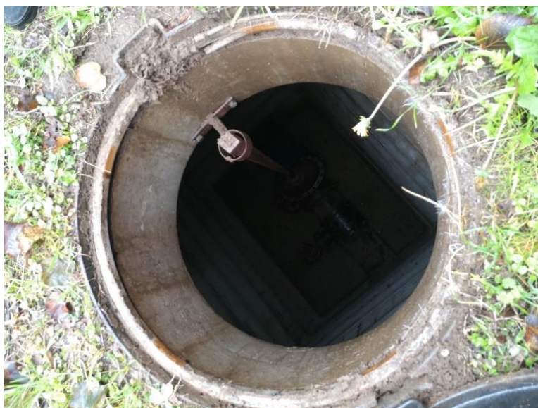
Figura 61 - Pozzetto di manovra ad elevata profondità
