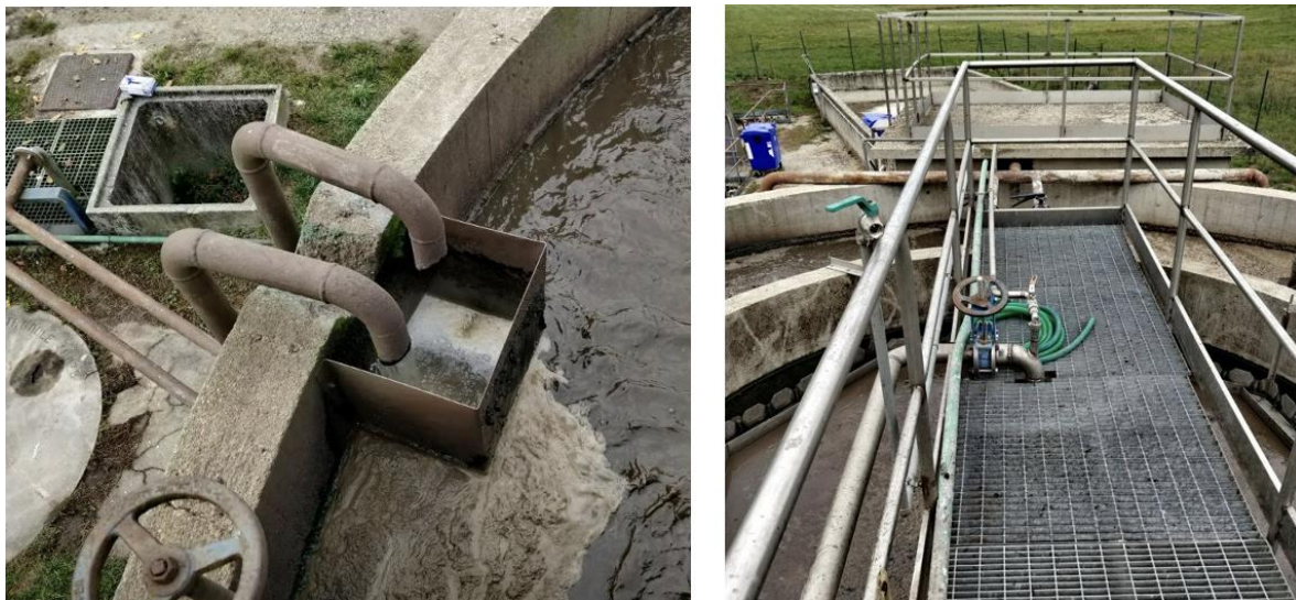
Figura 30 - Dettaglio ingresso da sollevamento (sx) e passaggio fisso (dx)
