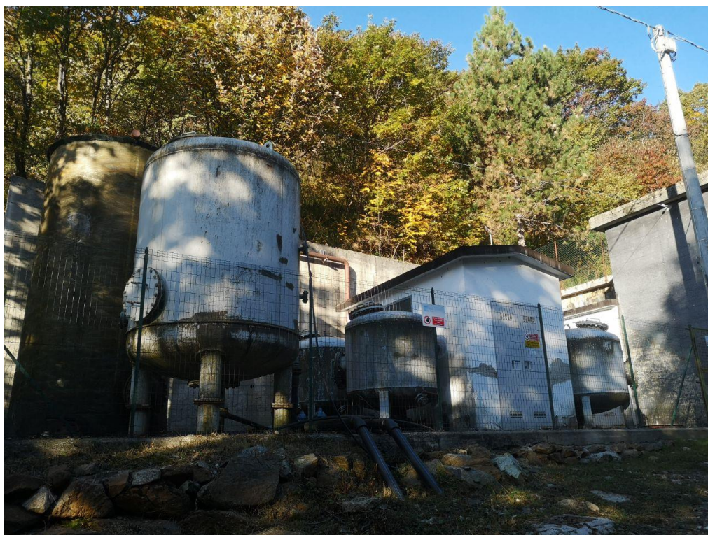
Figura 38 - Impianto di depurazione Borlera
