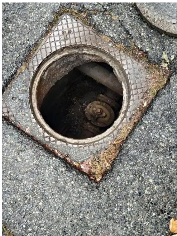
Figura 60 - Pozzetto di manovra
