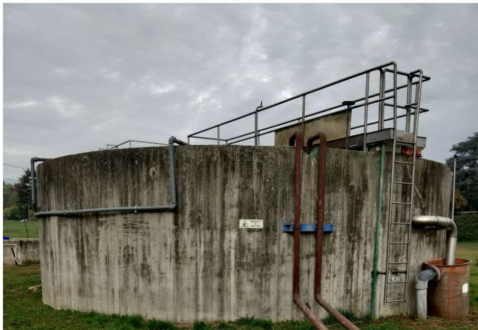
Figura 29 - Dettaglio vasca ossidazione
