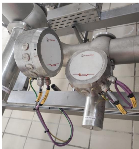
Figura 8-Due sensori di misura L-Com posti in serie nella linea di Filtrazione
