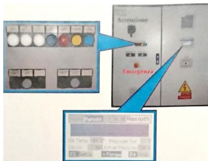
Figura 3: Pannello principale per l'accensione e il monitoraggio della centrale
