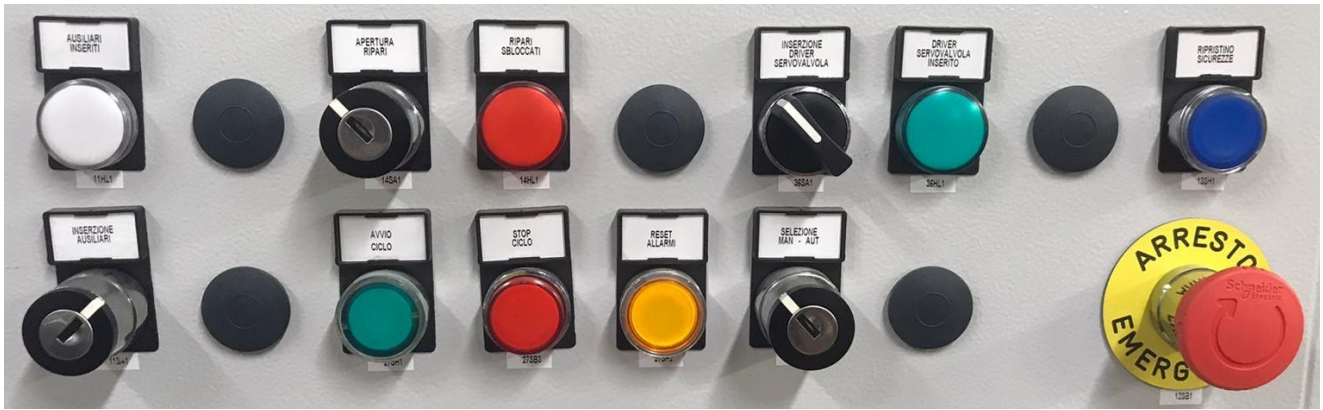
Figura 43-Pannello di controllo elettromeccanico
