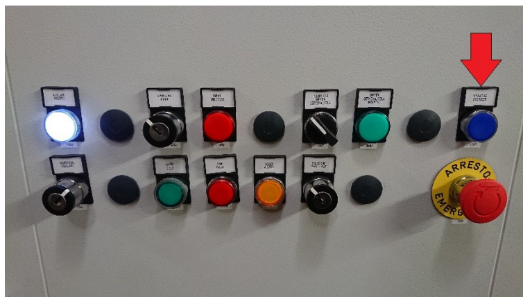
Figura 10 - Pannello di Controllo, Riattivare Funzionalità
