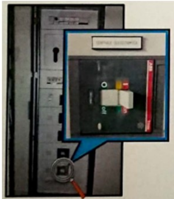
Figura 4: Quadro elettrico generale
