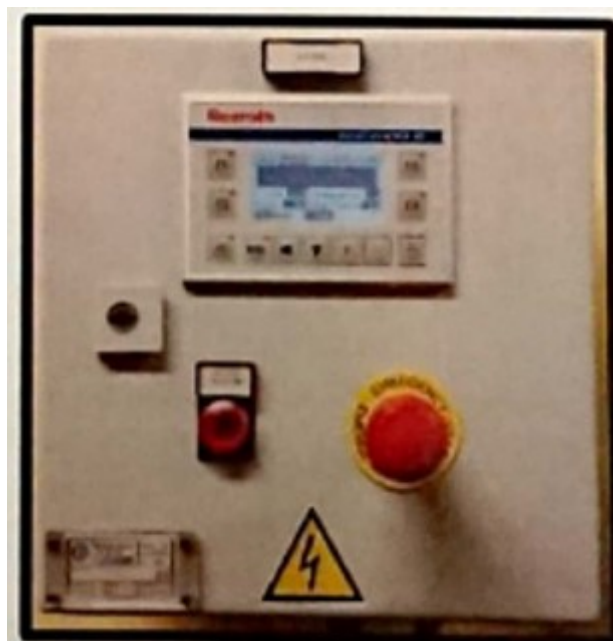
Figura 5: Pannello di monitoraggio dislocato
