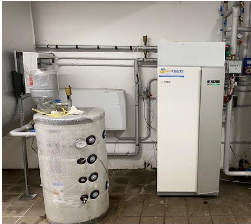
Figura 32: Pompa di calore geotermica (destra), ventilconvettore (dietro), volano termico (sinistra)
