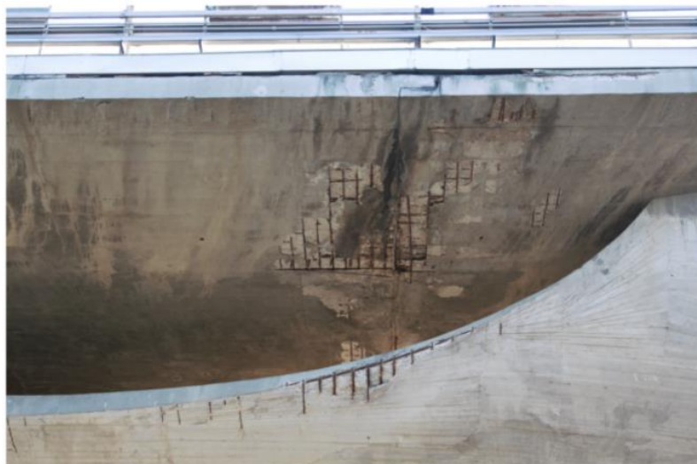
Figura 2.12 - Dettaglio deterioramento sella Gerber del ponte Musmeci, [56]
