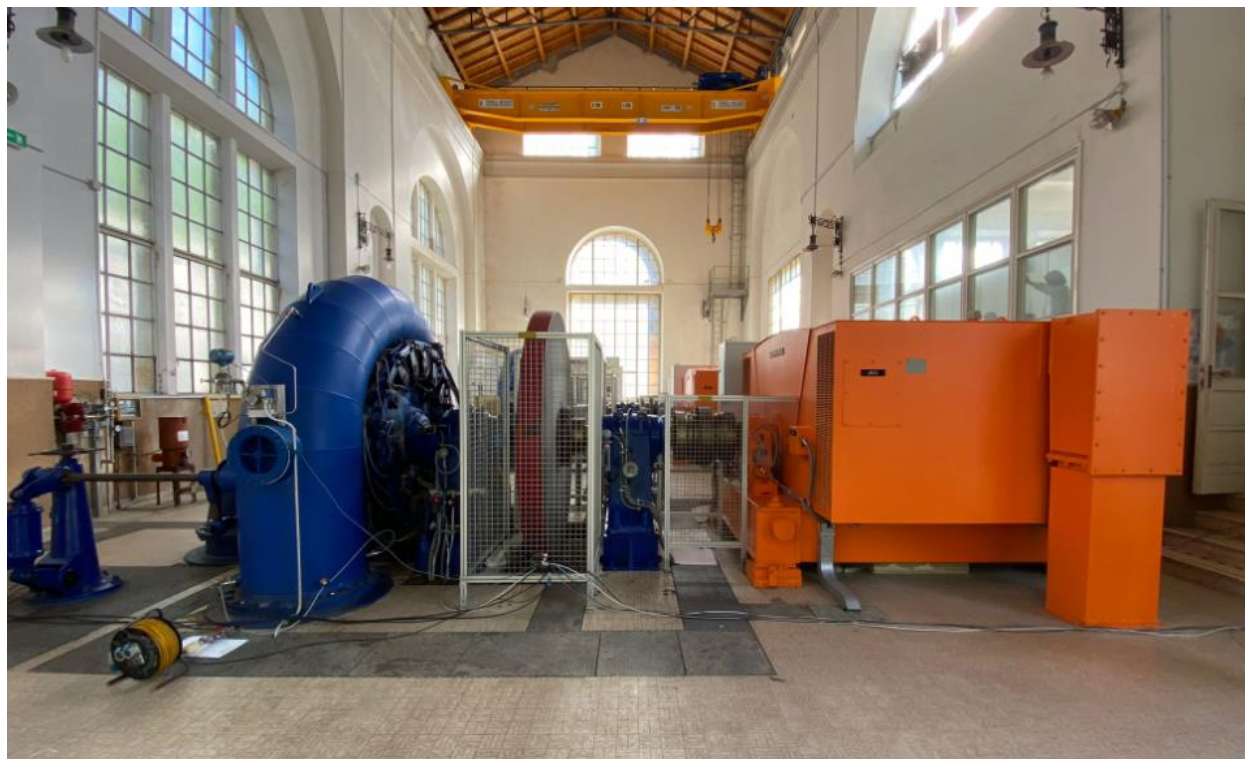
Figura 2. 4 : Interno centrale idroelettrica Strettara
