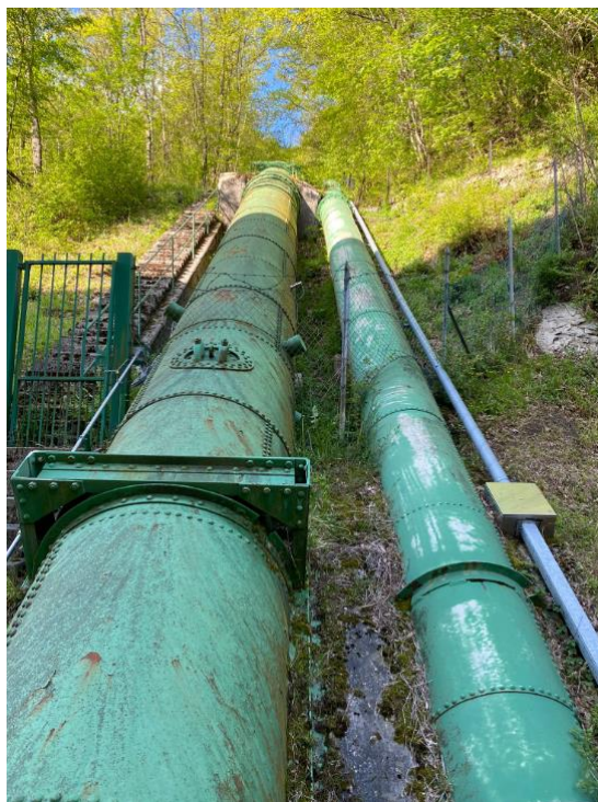
Figura 2. 3 : Condotta forzata presente in impianto
