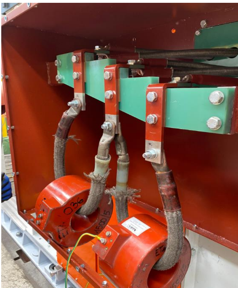
Figura 5. 5 : Chiusura dell'avvolgimento in corto e posizionamento TA di misura
