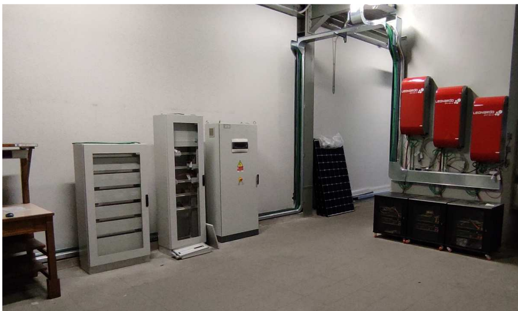
Figura 2-15: Foto del locale completo in cui si può osservare il percorso delle canaline e la posizione dei componenti dell'impianto.
