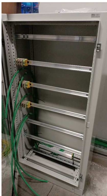
Figura 6-11: Quadro AC senza piastre di completamento, in cui si può osservare le morsettiere, i cavi e le guide
