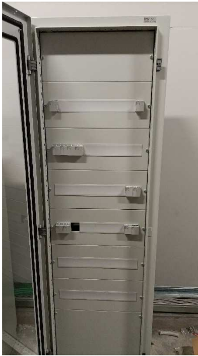
Figura 6-1: Quadro DC con piastre di completamento
