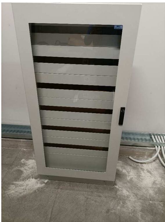
Figura 6-10: Quadro AC con piastre di completamento
