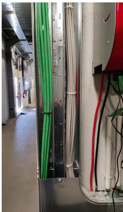
Figura 2-13: Dettaglio della canalina interna al locale, in cui si può osservare la separazione in setti della canalina: a sinistra i cavi AC, in centro i cavi di segnale e a destra i cavi DC.
