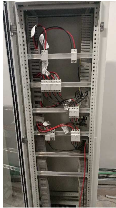
Figura 6-2 Quadro DC senza piastre di completamento, in cui si può osservare i portafusibili, i cavi solari e le guide
