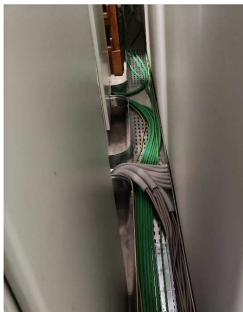
Figura 2-14: Canalina posizionata dietro i quadri AC e DC, in cui si può osservare gli ingressi ai quadri.
