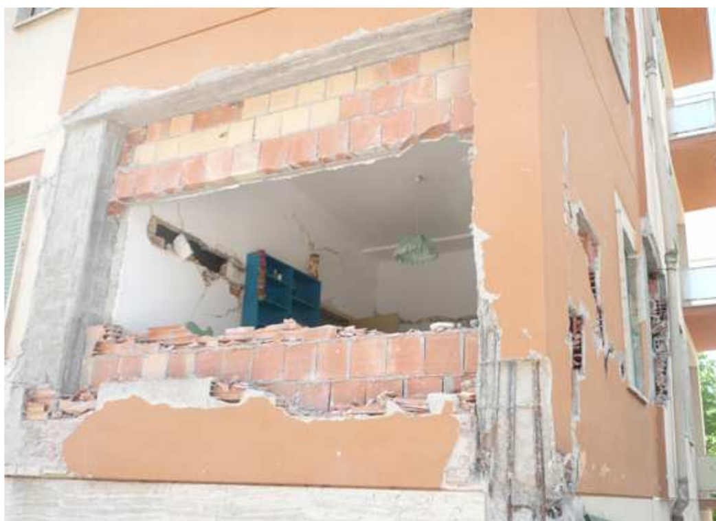
Crollo del muro di tamponamento
