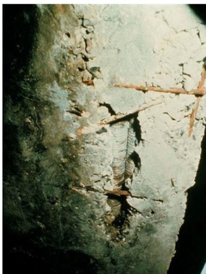
Figura 2.10 Mancato rispetto delle distanze minime fra le guaine dei cavi di precompressione. La distanza insufficiente impedisce il corretto costipamento del calcestruzzo e protezione delle guaine, con evidenti problemi per la durabilità delle stesse e dell'armatura in esse contenuta. La figura è tratta da [10].
