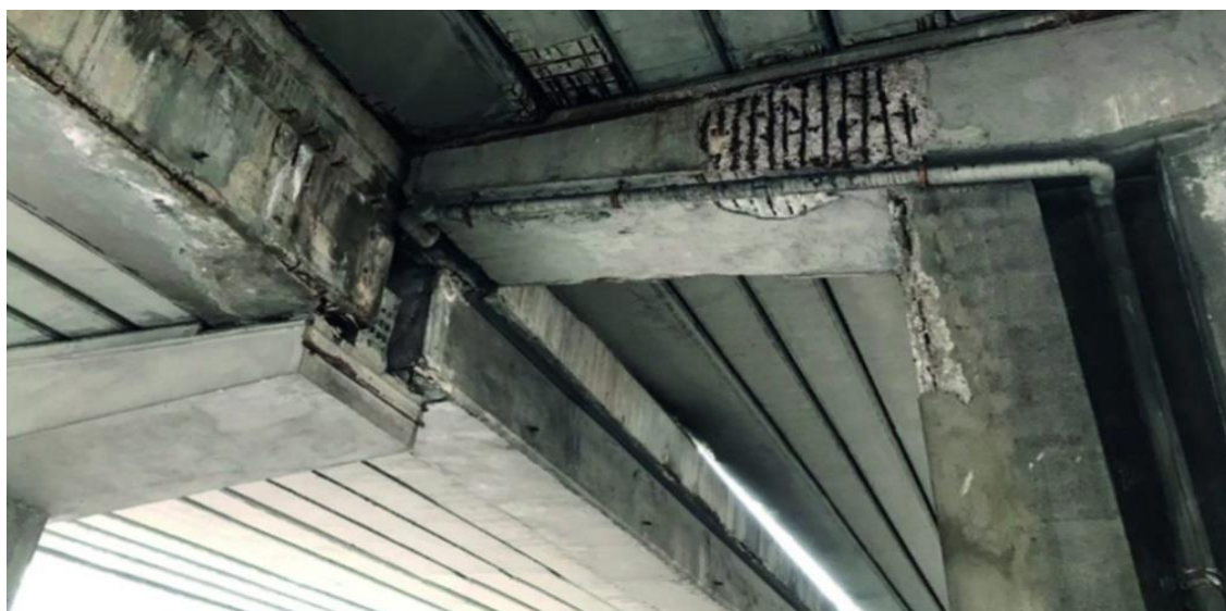
Figura 2.11 Importanti fenomeni di degrado diffuso sulle zone terminali delle travi, sul pulvino e sulle pile. Si osservano ampie zone caratterizzate da corrosione delle armature e distacco dei copriferri. Il fenomeno è originato con ogni probabilità dalla percolazione disordinata e non correttamente regimata dei liquidi di impalcato attraverso i giunti. La figura è tratta da [35].
