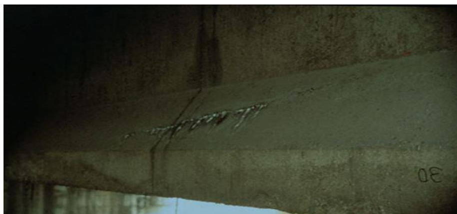
Figura 2.12 Fessurazioni lungo lo sviluppo longitudinale dei cavi con formazione di efflorescenze. La figura è tratta da [10].
