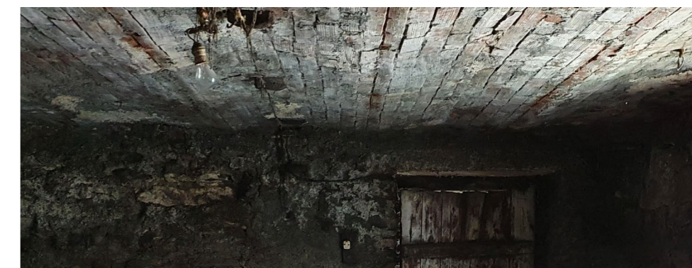
Figura 6.34 Solaio in ferro e voltine in laterizio al piano terra della Congregazione . Foto acquisita il 21/10/2020
