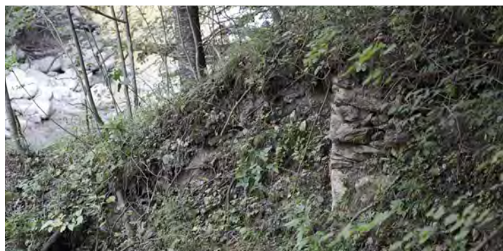
► Sezione del muro di sostegno della Strada visibile in corrispondenza del cedimento dell'argine destro.
