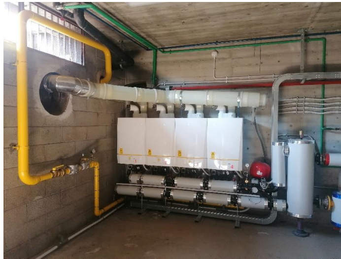
Figura 42: Centrale termica con caldaie
