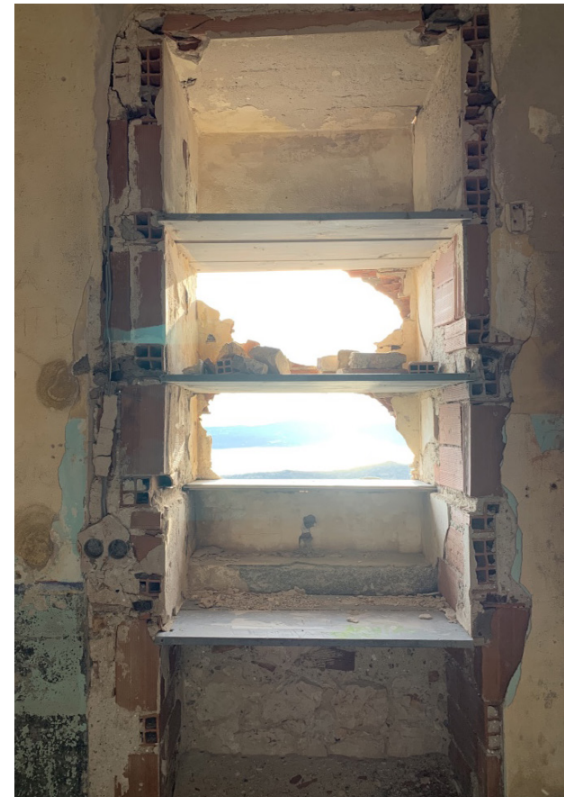
Fig.54 Le aperture finestrate trasformate in vani per l'appoggio di mensole di legno (fonte: foto dell'autore).
