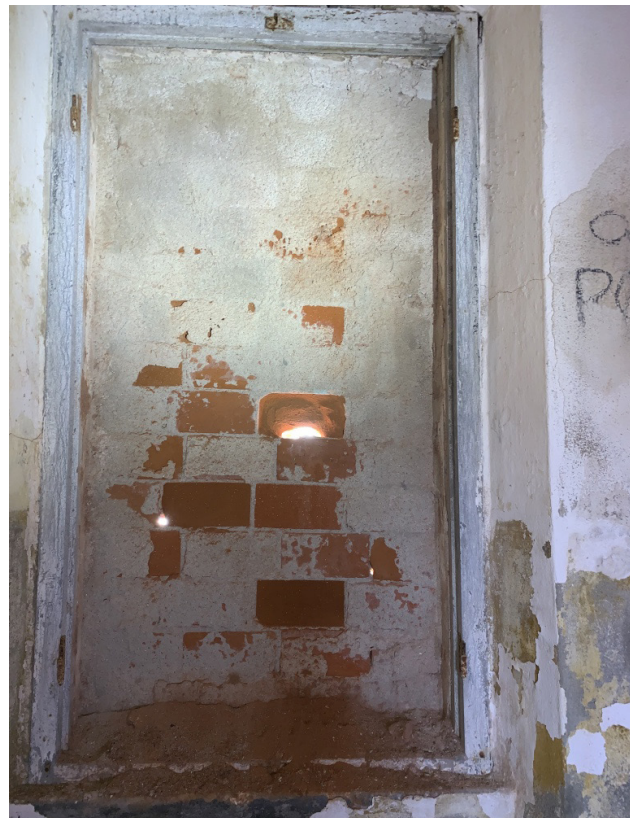
Fig.60 Chiusura della maggior parte delle finestre con mattoni forati (fonte: foto dell'autore).
