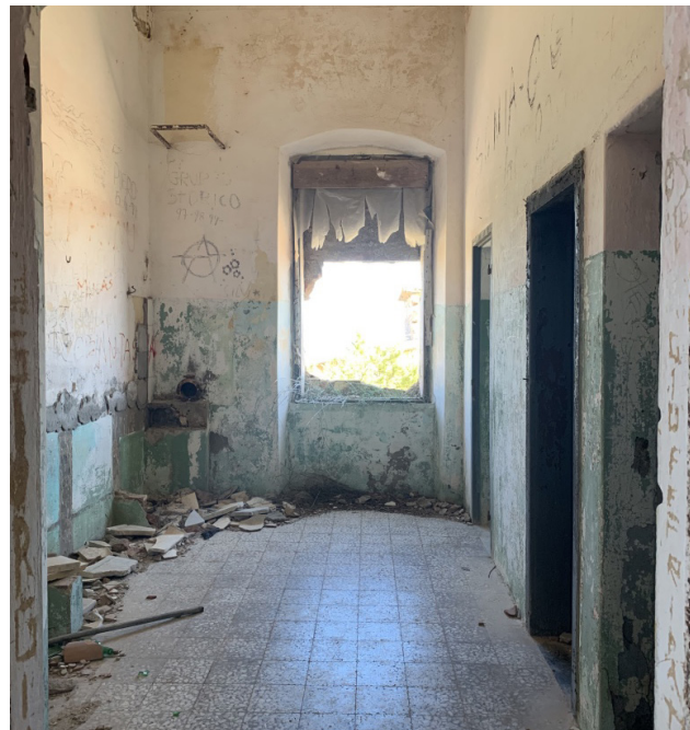
Fig.52 Le tracce dell'impianto della cucina (fonte: foto dell'autore)
