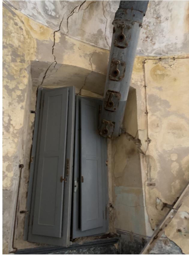
Fig.55 L'antenna che spinge sull'aparato murario (fonte: foto dell'autore).
