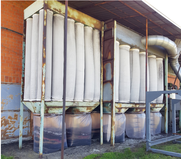
Figura 3 - Impianti di aspirazione di una azienda tessile
