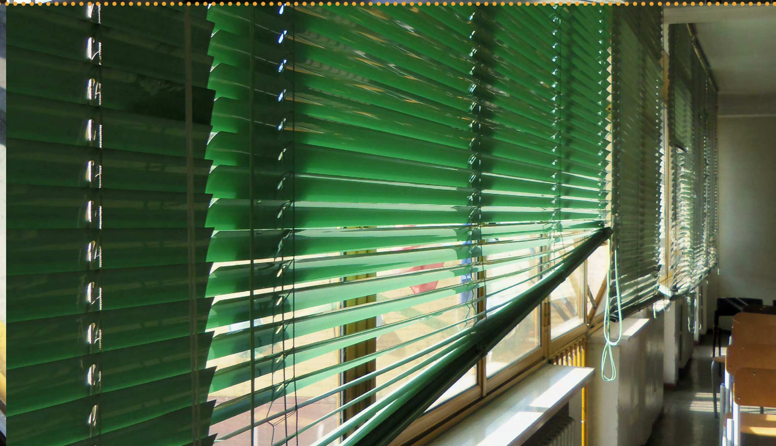
Come si evince dalle foto, le schermature esterne sono deteriorate e andrebbero sostituite con tecnologie più innovative e funzionali. Considerata l'esposizione, bisogna inoltre prevedere dei sistemi di protezione solare al fine di evitare fenomeni di abbagliamento durante le prime ore del mattino. I telai, realizzati in ferro, sono caratterizzati da basse prestazioni termiche. Le guaine si presentano in uno stato di degrado avanzato e potrebbero essere causa di infiltrazioni.
