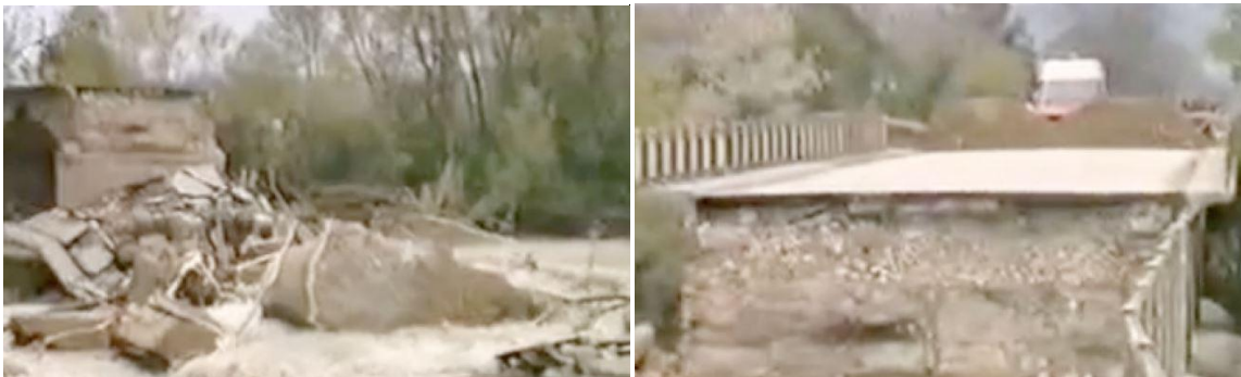
Figura 2.13 - Immagini del crollo del ponte sul fiume Tavo 16
