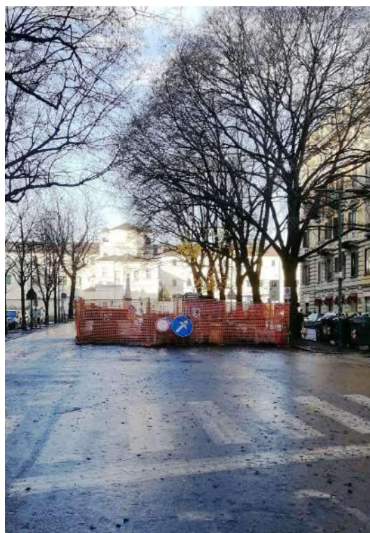
Fig. 9 - Il cantiere IREN ha reso impossibile il passaggio veicolare nell'ultimo tratto di Corso Marconi (foto personale, Novembre 2019)
