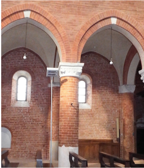
Fig. 2.3.26 Rivalta Scrivia. Pilastro debole cilindrico in laterizi
