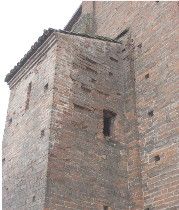
Fig. 7.23 Torre scalare. Ammorsamento tra le murature PNc012 e PNc014
