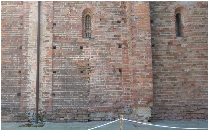
Fig. 2.3.33 Rivalta Scrivia. Contrafforti in laterizio a blocco unico
