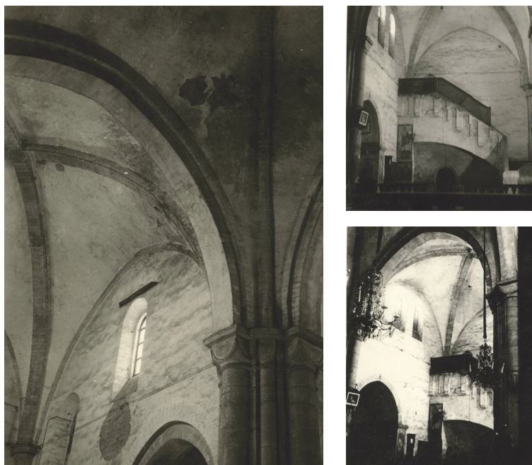
Fig. 3.8 Stato di degrado delle coperture voltate (in Archivio Fotografico SABAP-TO, AL_Tortona_3885/3886, ottobre 1942)
