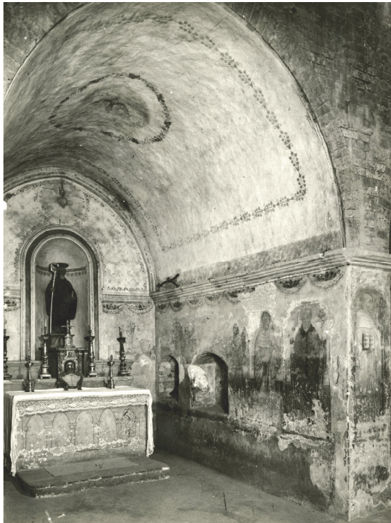
Fig. 3.9 Stato di degrado delle superfici affrescate (in Archivio Fotografico SABAP-TO, AL_Tortona_3885/3886, ottobre 1942)
