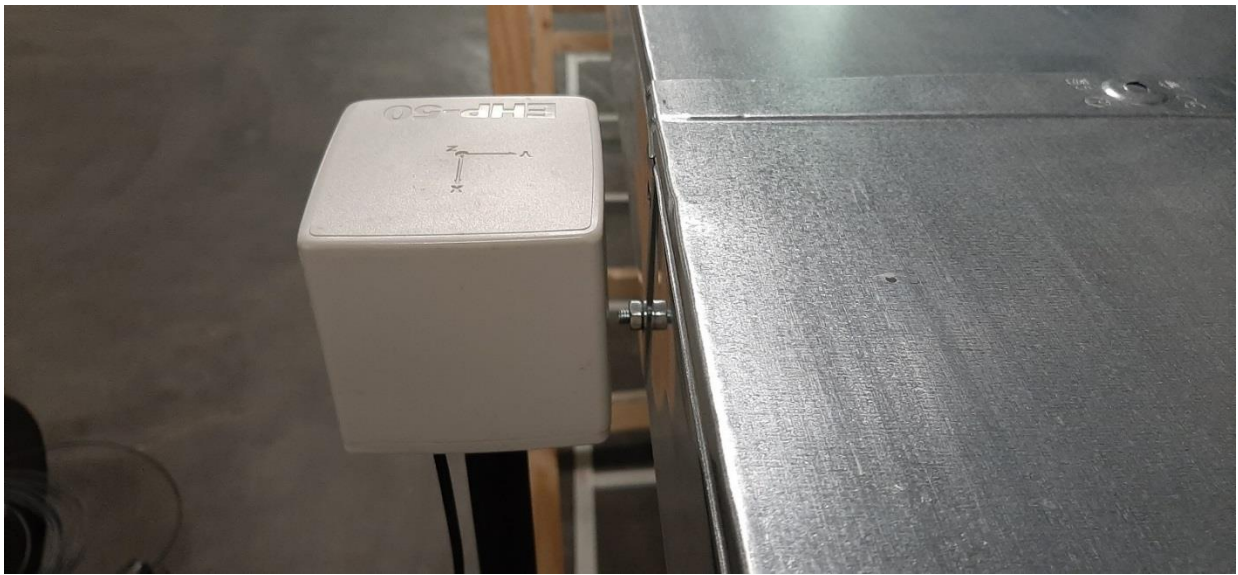
Figura 8 Posizionamento sonda all'interfaccia dei giunti alla prima impostazione delle misure del canale.
