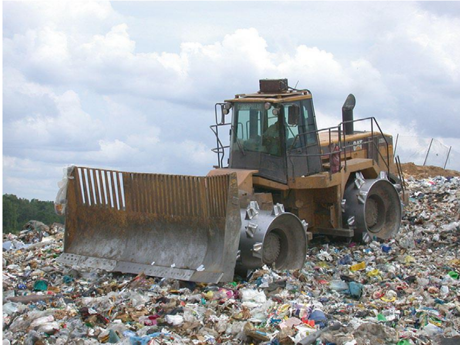
Figura 1.4: compattazione dei rifiuti, immagine tratta da “Sustainable Practices for Landfill Design and Operation”
