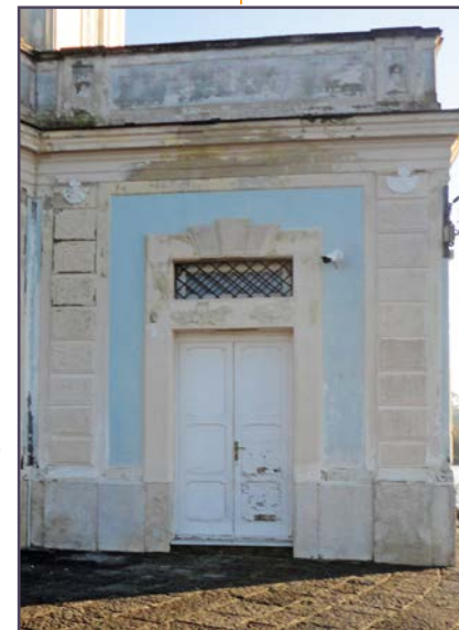
tav.26. Rilievo Termografico - PROSPETTO NORD-OVEST. SCHEDA 6
