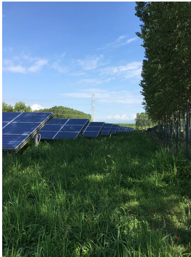
Figura 6.3. Shading distribuito su moduli fotovoltaici Inverter 1
