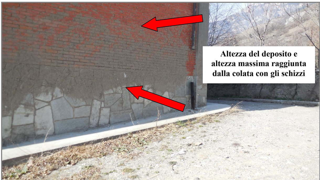
Figura 52: rilievo in campo delle altezze del deposito e dei danni (4) – Particella 1008
