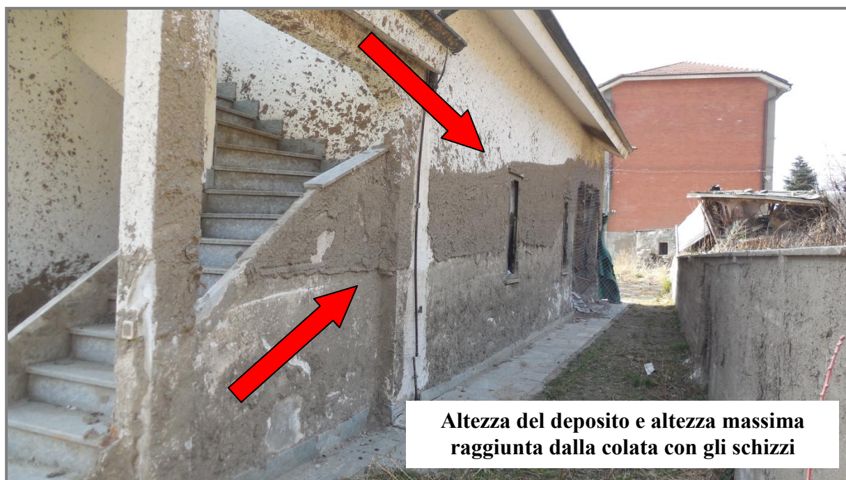
Figura 54: rilievo in campo delle altezze del deposito e dei danni (6) – Particella 935
