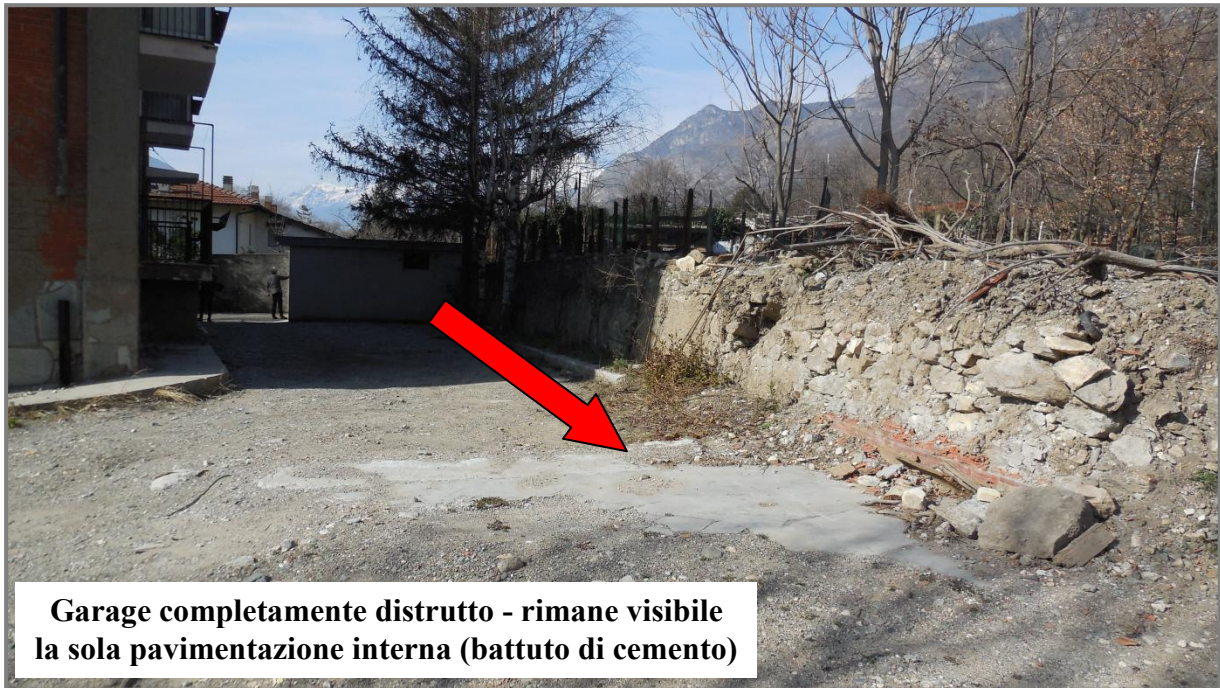
Figura 51: rilievo in campo delle altezze del deposito e dei danni (3) – Particella 994
