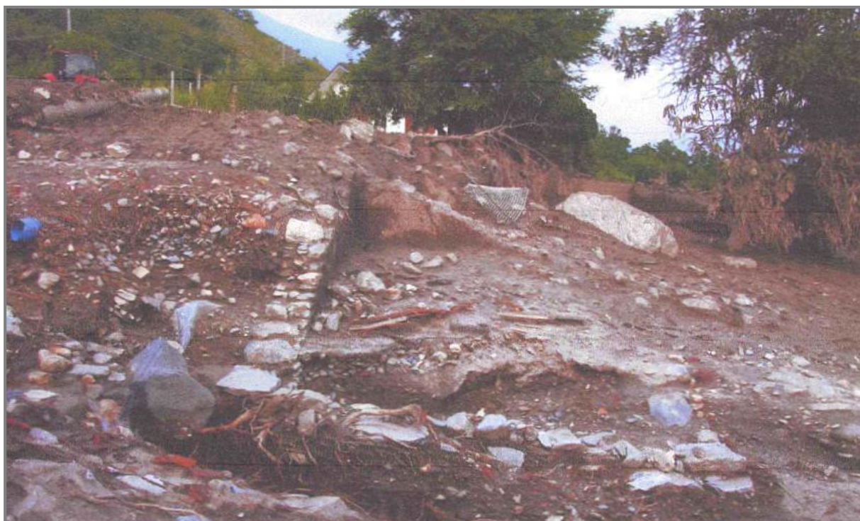
Figura 113: foto dei resti sul terreno del catastale 1139 dopo il passaggio della colata detritica– vista lato ovest (foto inserita nella richiesta danni allo Sportello Edilizia del Comune di Bussoleno)
