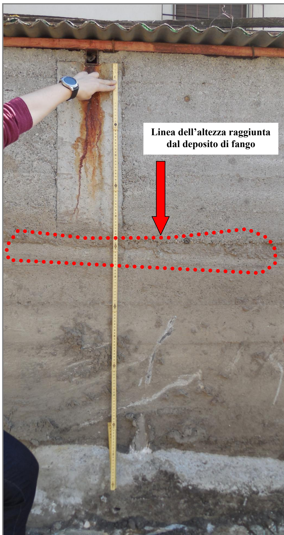
Figura 50: rilievo in campo delle altezze del deposito e dei danni (2) – Particella 993
