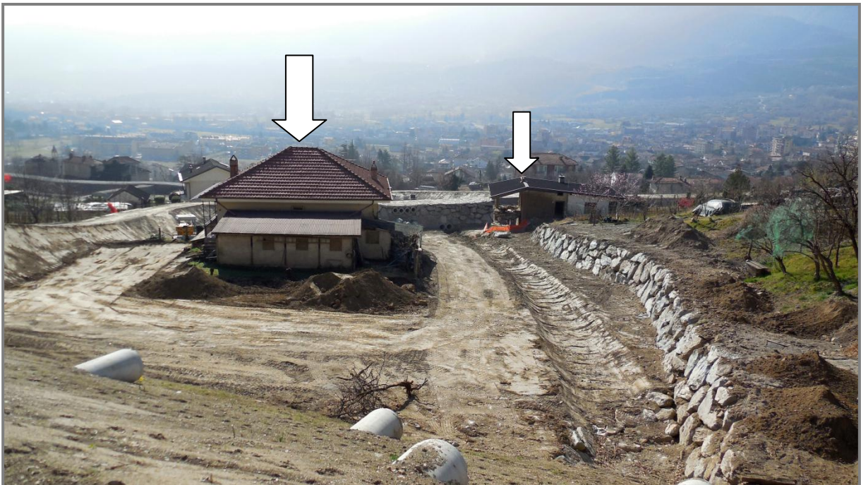
Figura 121: bacino di accumulo supplementare da 6000 m 3 . Vista verso valle. In evidenza i catastali 993 e 377 che dovranno essere demoliti (foto scattata il 28/02/2019)
