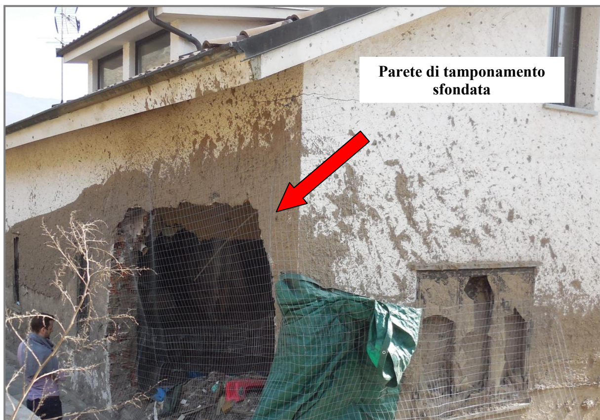
Figura 53: rilievo in campo delle altezze del deposito e dei danni (5) – Particella 935
