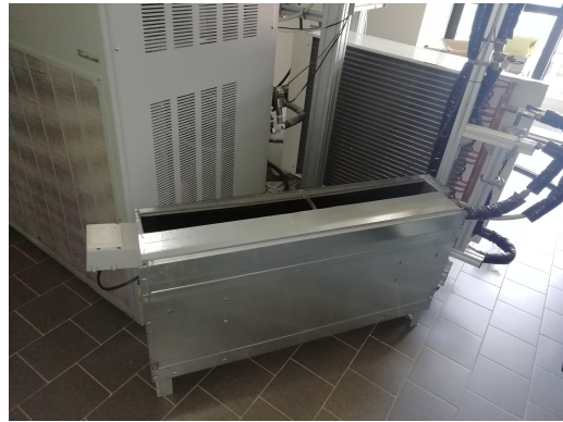
(b) Fan coils
