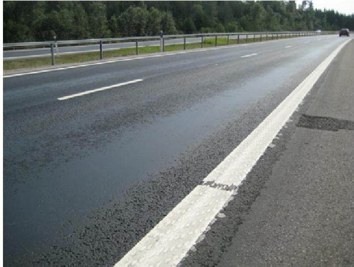
Figura 2.8: Bleeding di una pavimentazione
