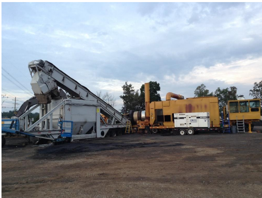
Figura 2.9: Impianto di produzione HMA
