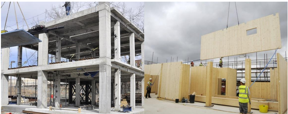
Figura 31 - Confronto tra le due tecnologie costruttive: calcestruzzo armato e Xlam, fonte: www.picswe.com
