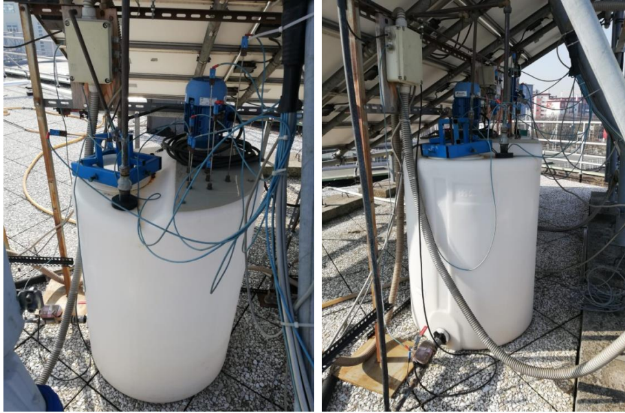
Figura 8.5 –Il serbatoio di accumulo
