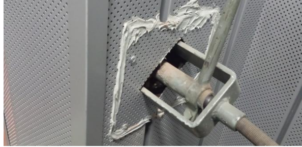
Figura 37: Particolare della situazione di alcuni pannelli a cui è stato effettuato un foro per il passaggio di una tubazione (collegarsi alla Figura 36)
