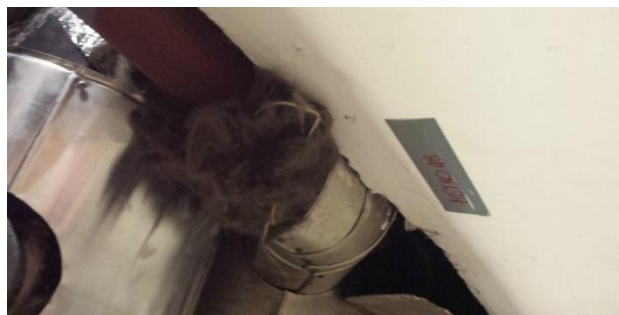
Figura 25: Particolare del degrado della coibentazione e della lana di vetro largamente esposta (contenuto di ossidi >18% e diametro medio <6 \mu\text{m} )
