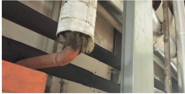
Figura 23: Particolare, visto dal cono ottico 3 di Figura 20, del degrado della struttura coibentante i tubi
