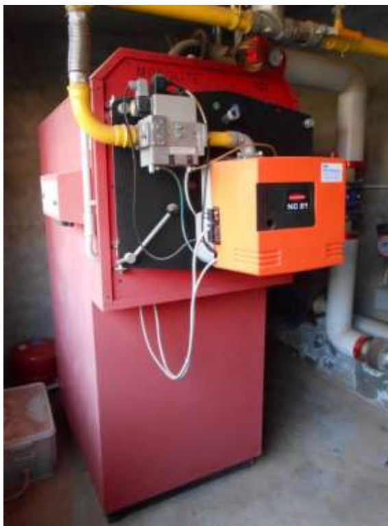
Fig. 5.3 –Generatore di calore impianto riscaldamento
