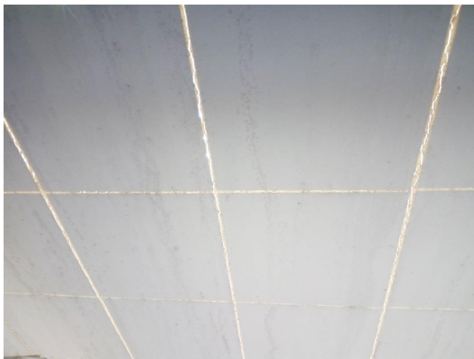
Figura 18 - dettaglio backsheet guasto impianto di Tummarello
