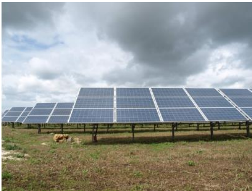
Figura 16 - veduta impianto fotovoltaico Pianomonaci, comune di Carlentini (SR), società IMAM Ambiente
