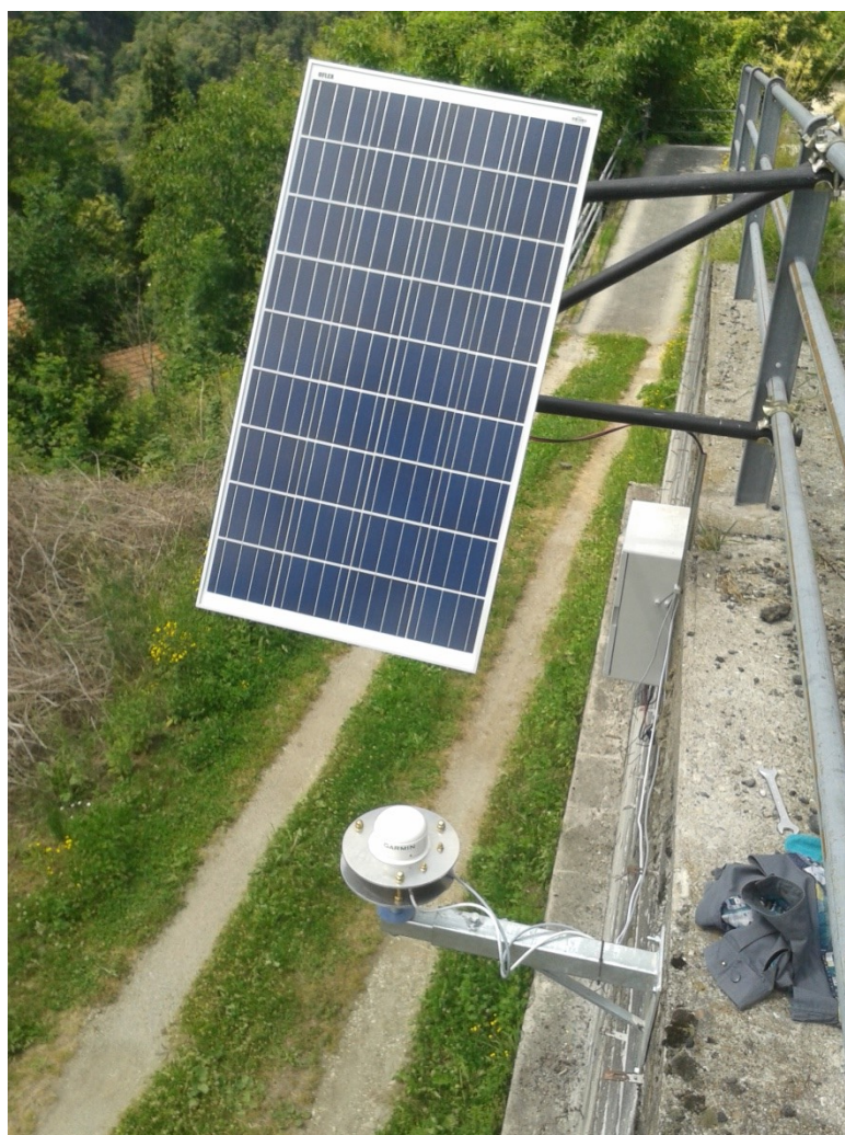
Figura 5: Sistema di monitoraggio con staffa e antenna GARMIN realizzato a Loreggia e alimentato da un pannello fotovoltaico
