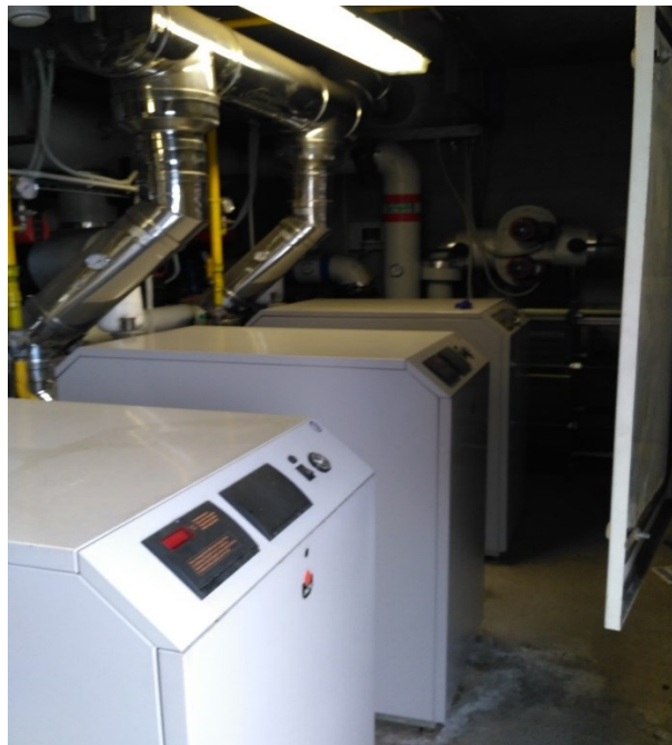
Figura 3.17 Centrale Termica "CT1"
