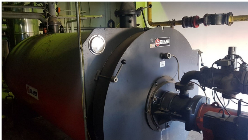
Figura 3.18 Centrale Termica “CT2”
