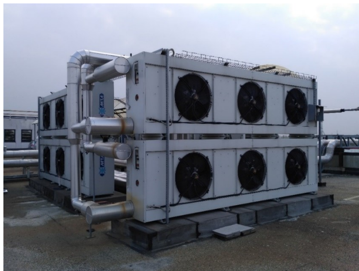
Figura 3.14 Impianto Free Cooling MTA RWD 150
