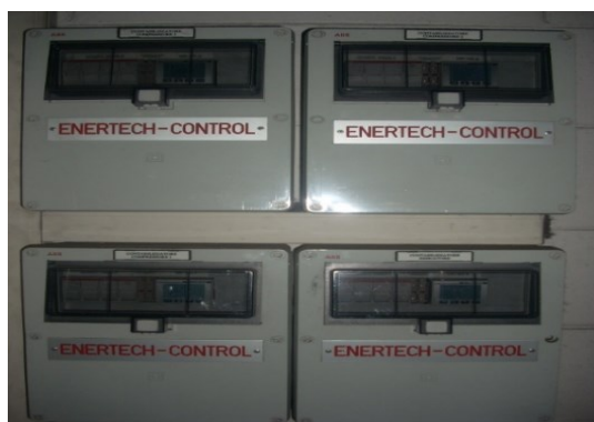
Figura 3.10 Multimetri centrale aria compressa
