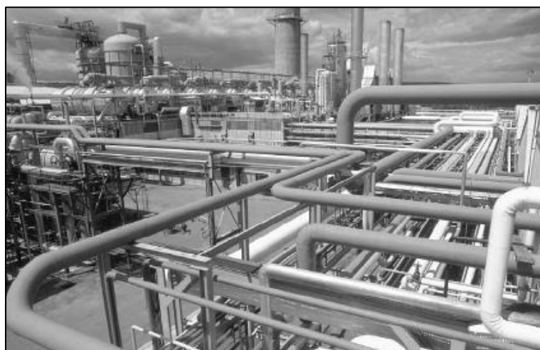
Figura 3.5.2 – Esempio di piping system particolarmente complesso
