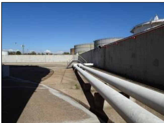
Figura 5.2.3 – Supporti all'interno delle vasche di contenimento
