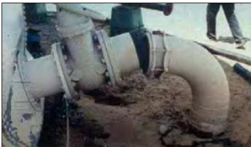
Figura 3.4.12 – Rottura del collegamento e imbozzamento del serbatoio
