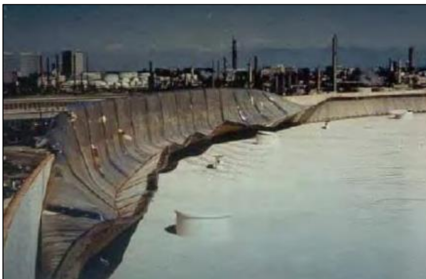
Figura 3.4.1 - Esempio di danneggiamento della copertura di un serbatoio
