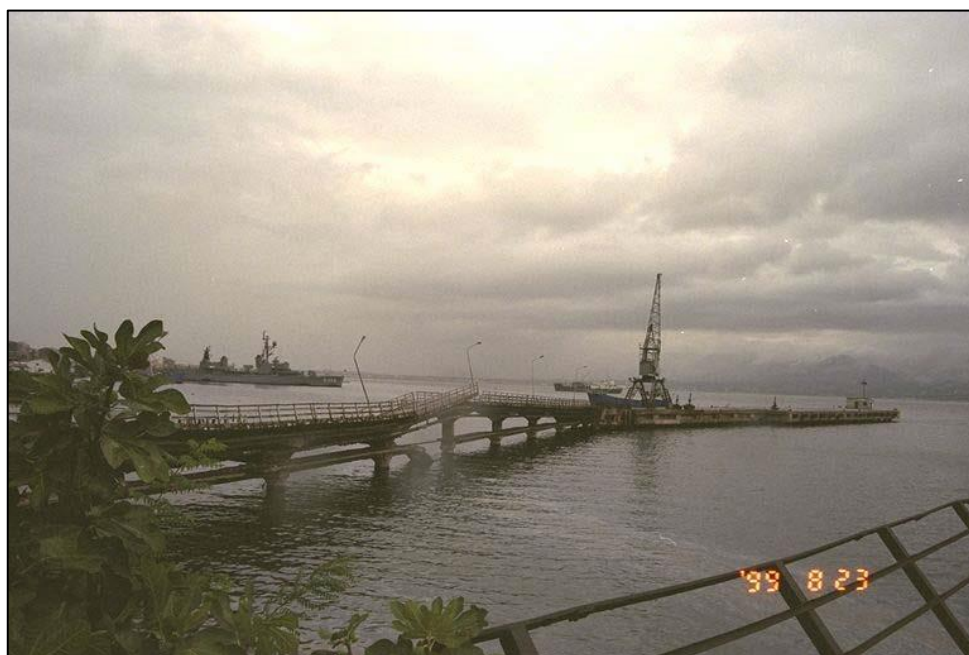
Figura 3.6.9 – Rottura della banchina portuale
