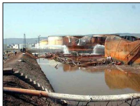
Figura 2.1 – Danneggiamento di un impianto a seguito del sisma (Turchia 1999)
