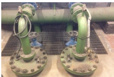
Fig. 3.11 Pompe rilancio zona 3
