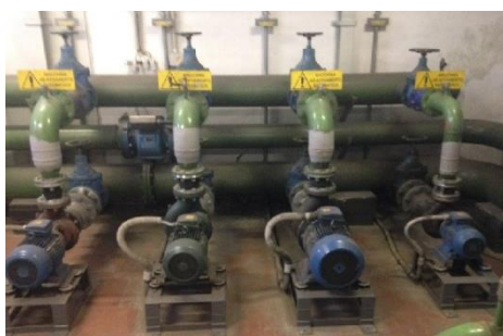
Fig. 3.9 Pompe rilancio zona 2
