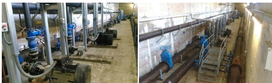
Fig. 3.14 Sala pompe Vadò
