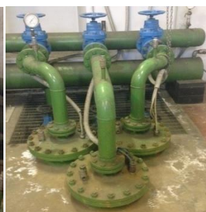
Fig. 3.10 Pompe rilancio zona 4
