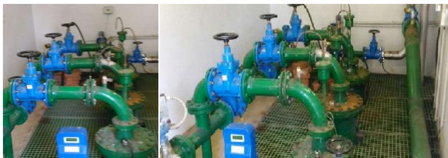
Fig. 3.16 Sala pompaggio San Bartolomeo e Revigliasco
