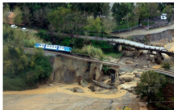
Figura 2.10: Incidente ferroviario – Crollo ponte ferroviario in Calabria
