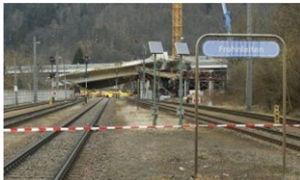
Figura 3.4: Crollo ponte stradale su ferrovia in Austria
