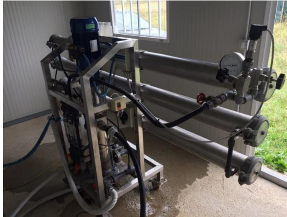
Figura 3.1: Immagine dell'impianto pilota in località 1
