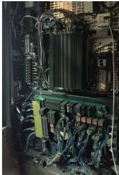
Figura 2. 6 Attuale apparato hardware AVM di bordo. Fonte: foto scattata (2017) all'interno di una vettura GTT
