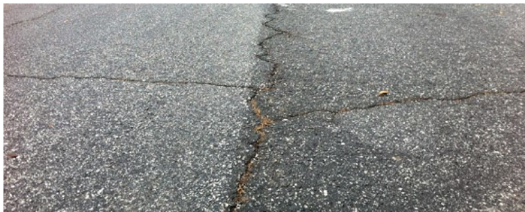
Figura1.4 fessurazione longitudinale e trasversale
