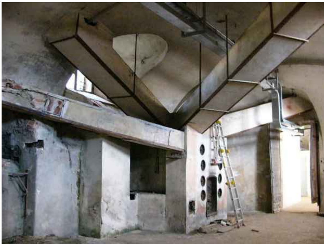
Uno dei dodici caloriferi ad aria posti nel piano interrato della Palazzina di Caccia di Stupinigi
