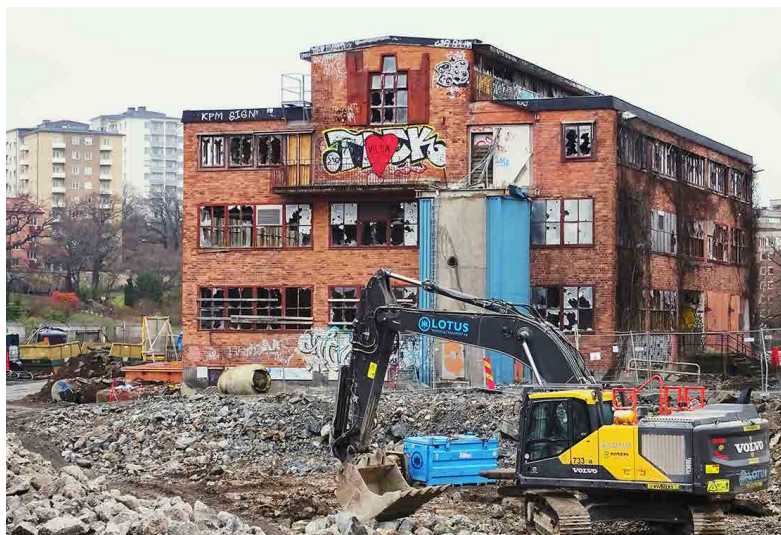
Fig. 127. Nitrolackfabriken, fabbrica di vernici nitro, in condizioni di abbandono. Autore: Holger Ellgaard, 2021.
