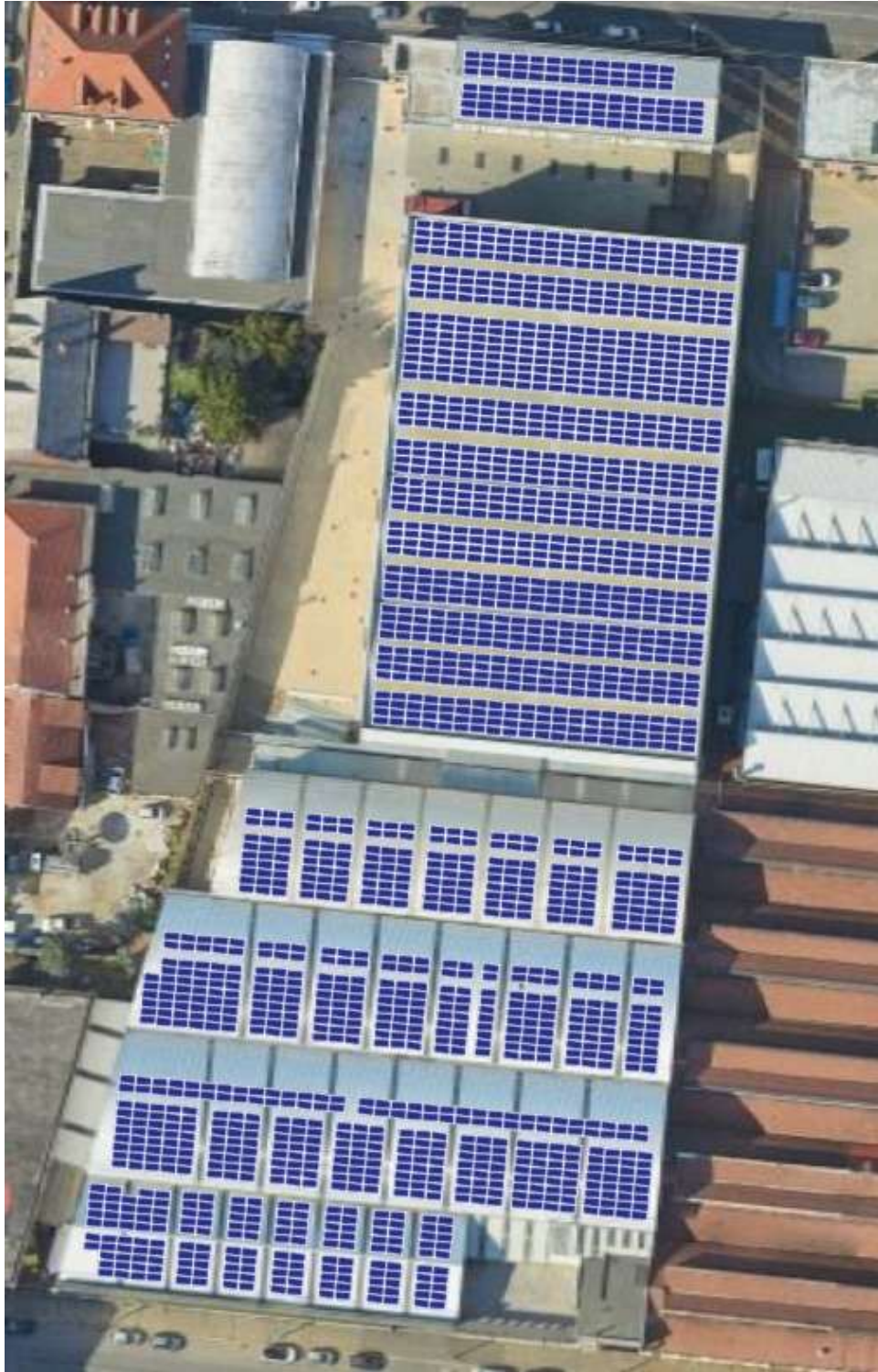
Figura 14 Vista dall'alto dell'impianto
