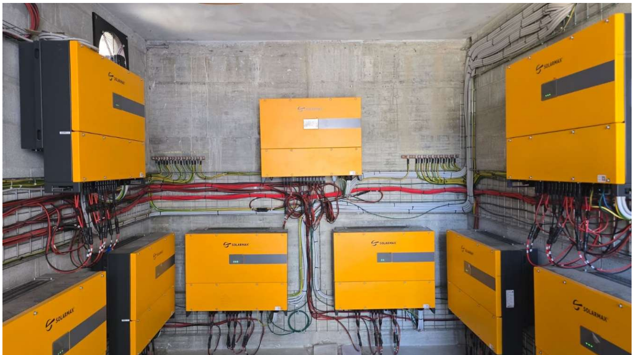
Figura 19 Visione parziale del locale inverter
