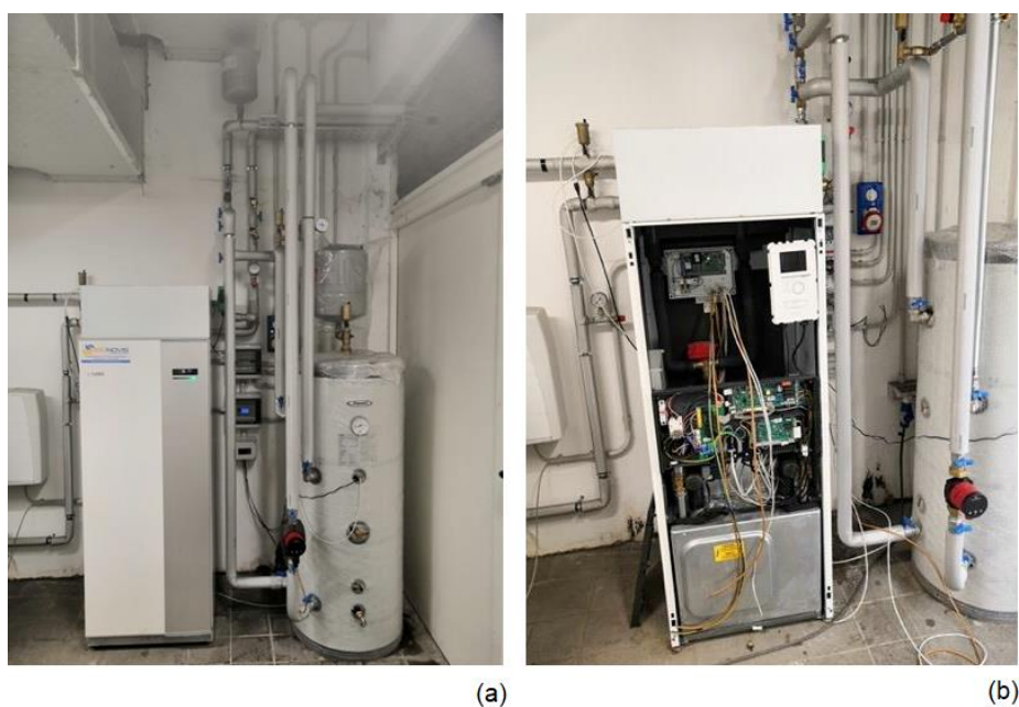
Figura 36: PdC e accumulo da 200 l (a); componentistica interna (b) 13 .
