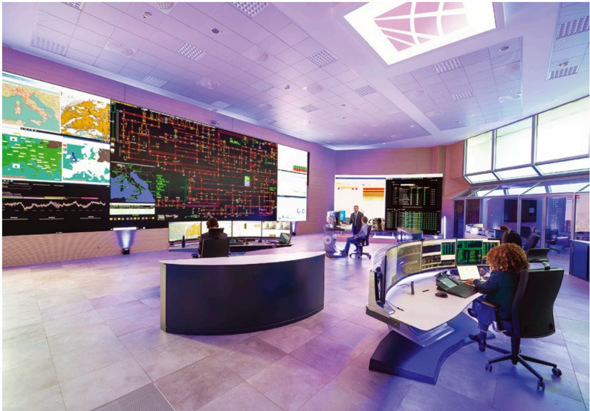
Figura 13 Centro Nazionale di Controllo di Terna S.p.A.
