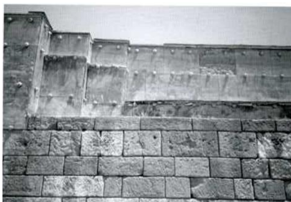
Figura 161 – Gela, mura greche di Capo Soprano. Particolare di un tratto della fortificazione in un'immagine del 1991 in cui si può notare la mancanza di una delle lastre di protezione, causa di infiltrazione d'acqua. .
