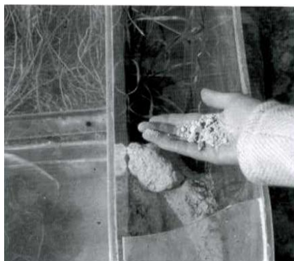
Figura 187 – Eraclea Minoa, dettaglio di un bracciolo di un posto in prima fila ormai privo del rivestimento in prespex. Nella foto scattata nel 1980 si può notare la totale disgregazione del materiale lapideo ormai ridotto ad un cumulo di sabbia.
