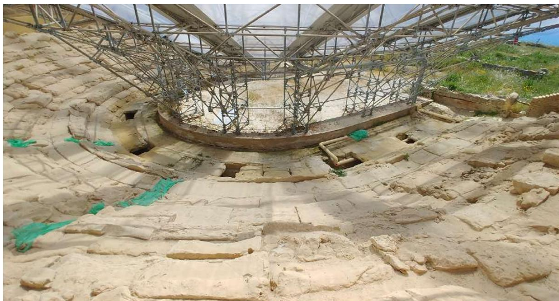
Figura 186 - Eraclea Minoa, vista interna del teatro sovrastato dalla copertura protettiva. Le forme di degrado degli elementi lapidei della cavea: fratturazioni, efflorescenze saline, disgregazione e depositi superficiali (foto G. M. Ventimiglia, 2023).
